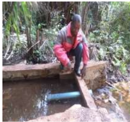
Figure 20 B: Captage d'une source d'eau potable a' Baho dans Baham
