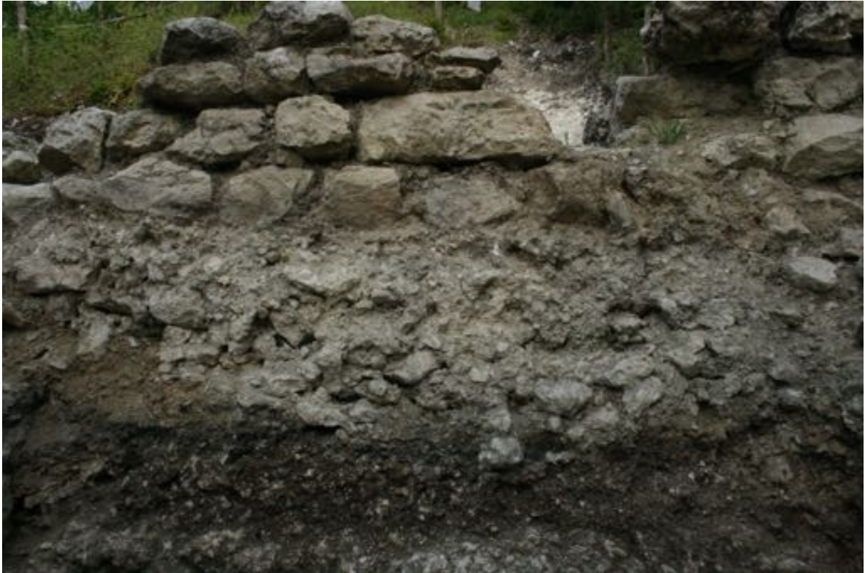
Fig. 131 : Détail de la reprise dans M-6
