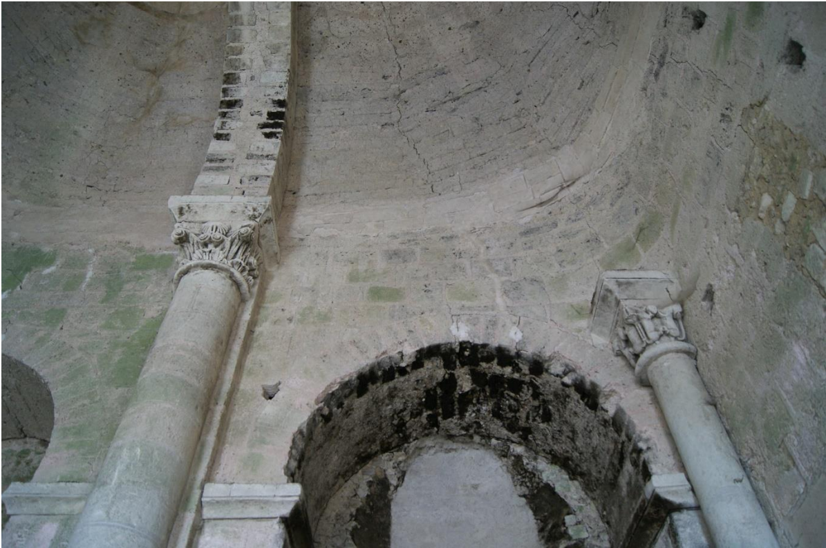
Illustration 5.22 – Face intérieure orientale de la tour, vue d’une colonne engagée et d’une colonnette d’angle au premier étage.
