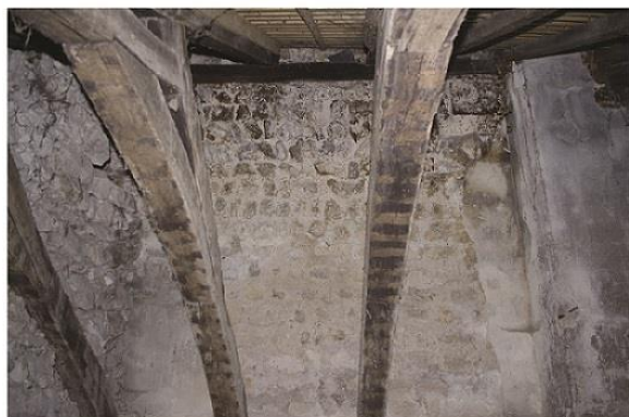
d. Vue de détail du parement du mur du collatéral nord de l'abbatiale (UC 20094)
