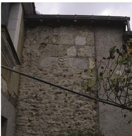
e. Vestiges du mur gouttereau du collatéral sud au 14 rue de l'abbaye.
