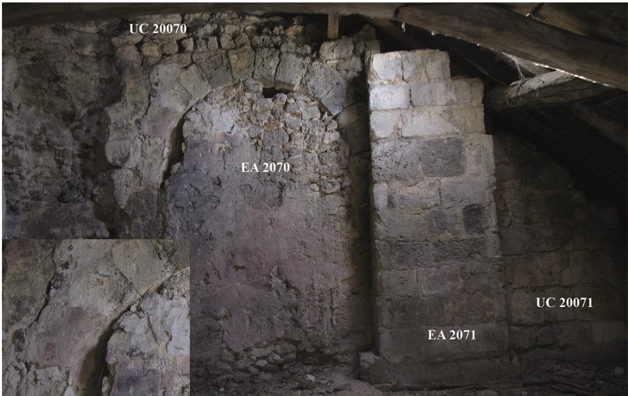
a. Vestiges romans situés du côté est au deuxième étage (M 231). Vue de l'enduit peint sur la baie (EA 2070)
