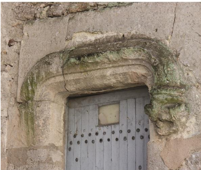
c. Logis de l'aumônier. Vue détaillée de la porte à linteau mouluré de la tourelle d'escalier
