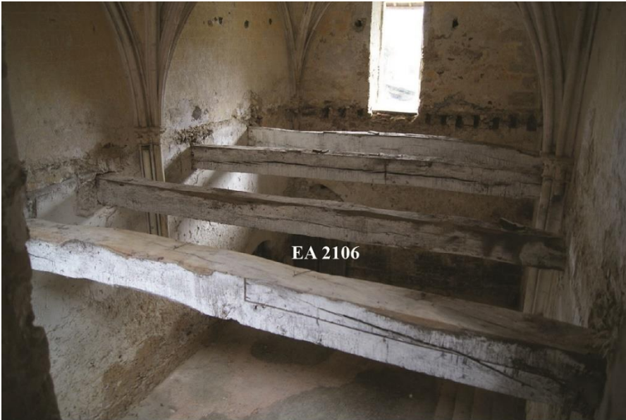
a. Porterie. Vue du premier niveau depuis la tourelle d'escalier à l'ouest
