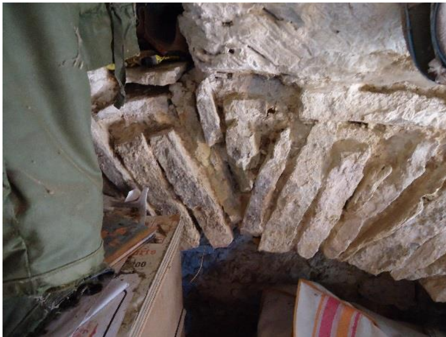
Figure 85 Porte méridionale bouchée, côté intérieur, clavage en superposition
