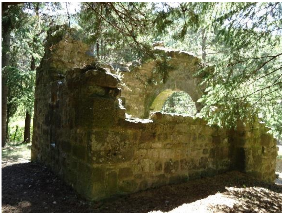
Figure 489 Vue nord-est du chevet
