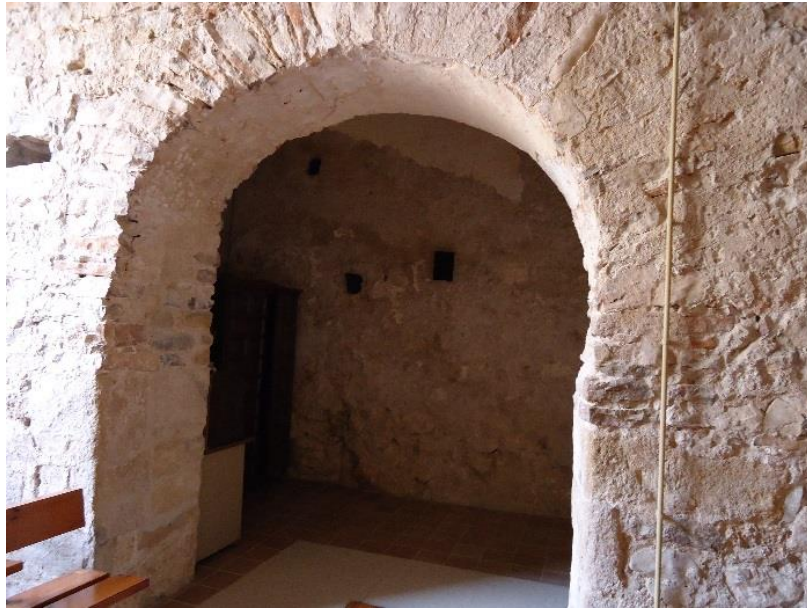
Figure 109 Arcade de la deuxième travée depuis l'ouest entre le vaisseau principal et le bas-côté nord
