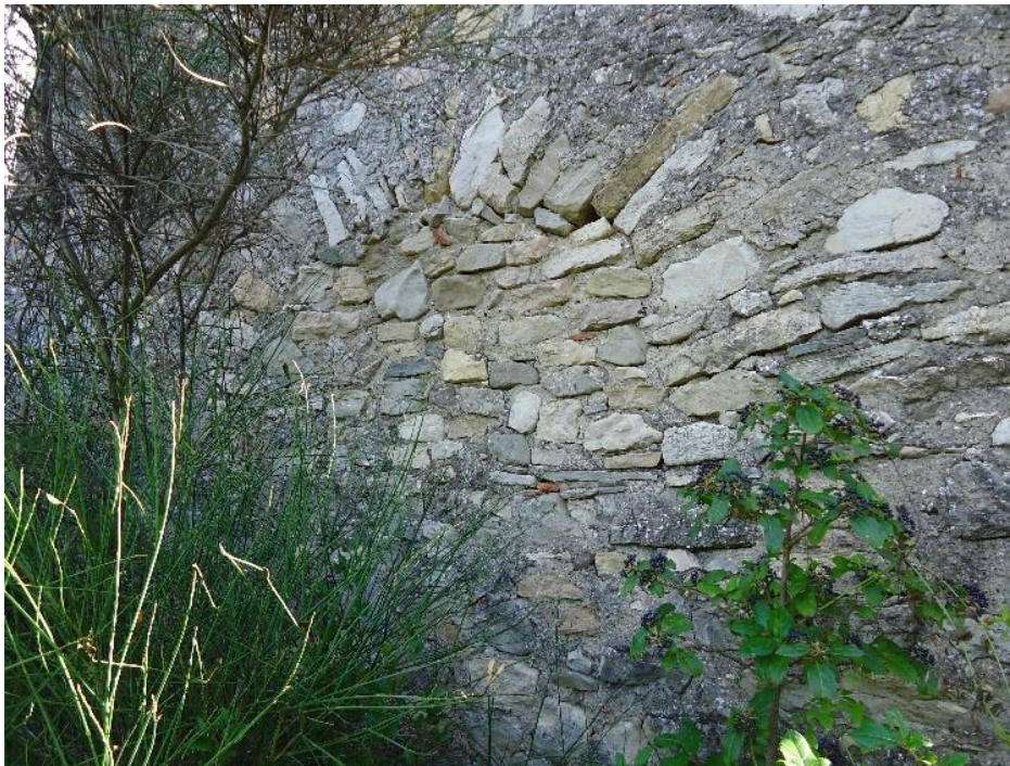
Figure 83 Porte occidentale murée
