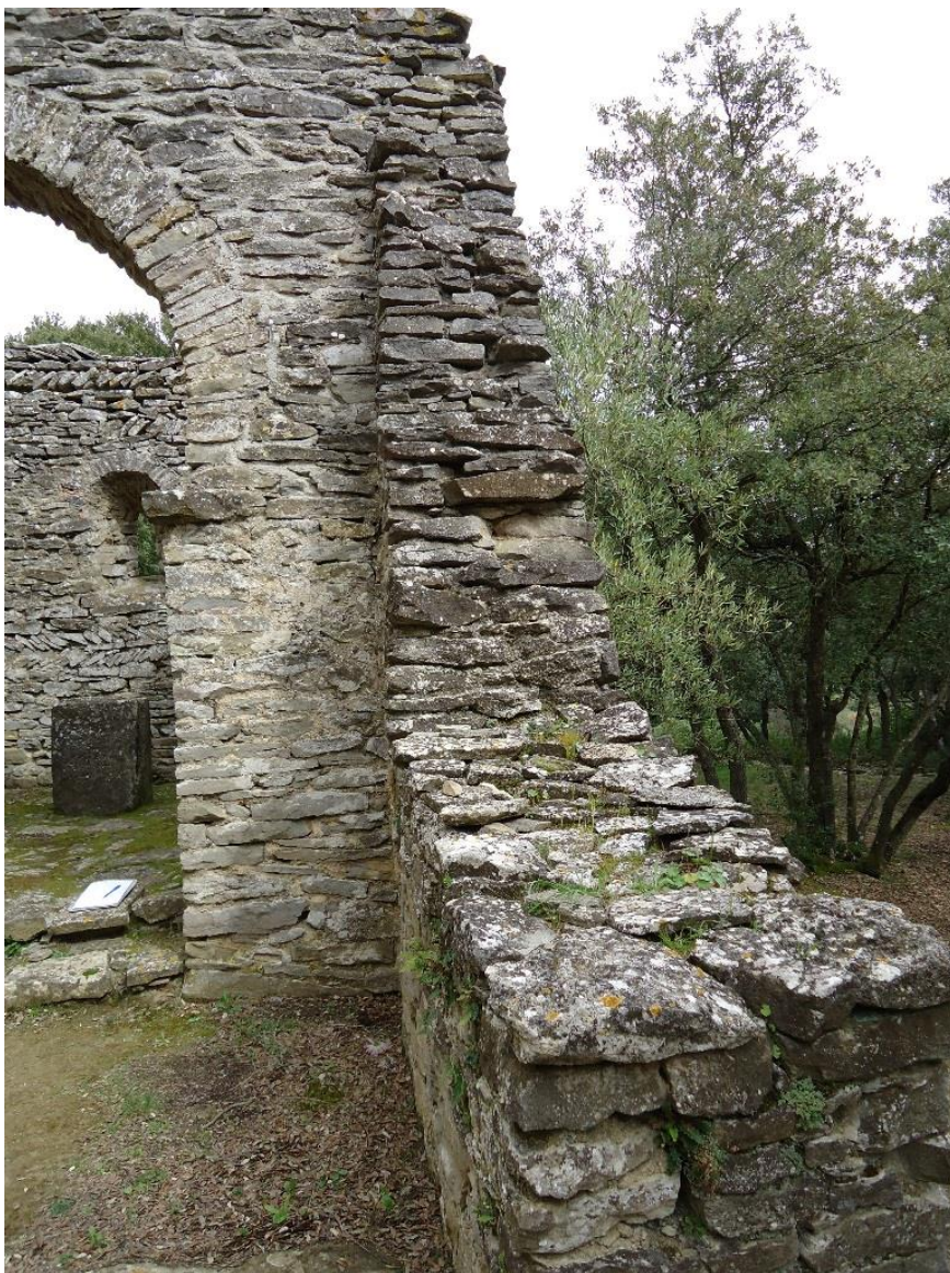
Figure 818 Mur sud de la nef amincissant en hauteur
