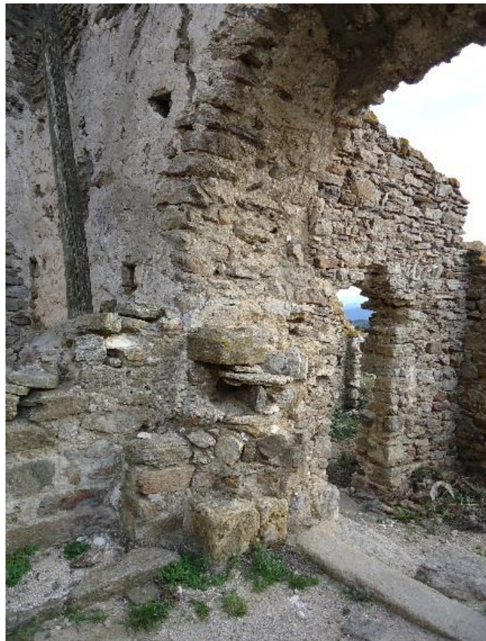
Figure 95 Pilier détruit de l'arc triomphal, côté sud
