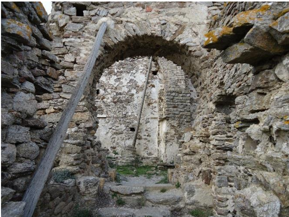
Figure 91 Porte méridionale avec piédroits détruits
