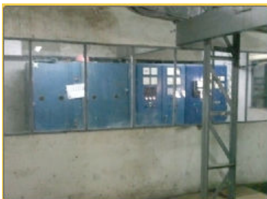
Cabine de contrôle
