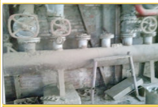
Barillet anciennes chaudières
