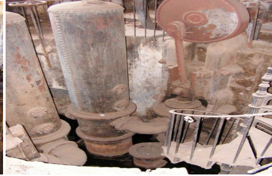
Pompe Le Blanc de l'usine 501
