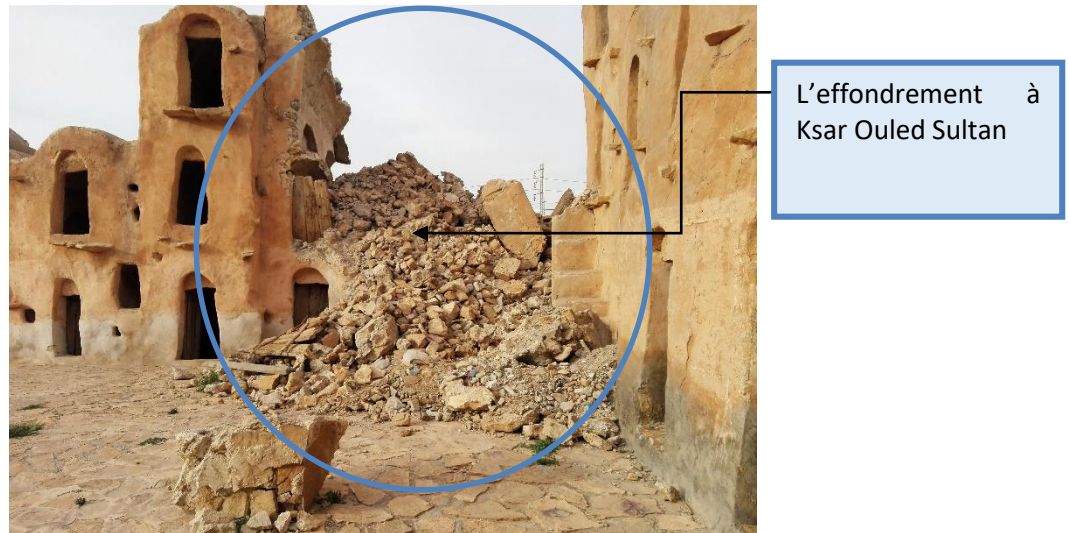
Figure 42 : Ksar Ouled Sultan, effondrement d'un pan entier de ghoraf
