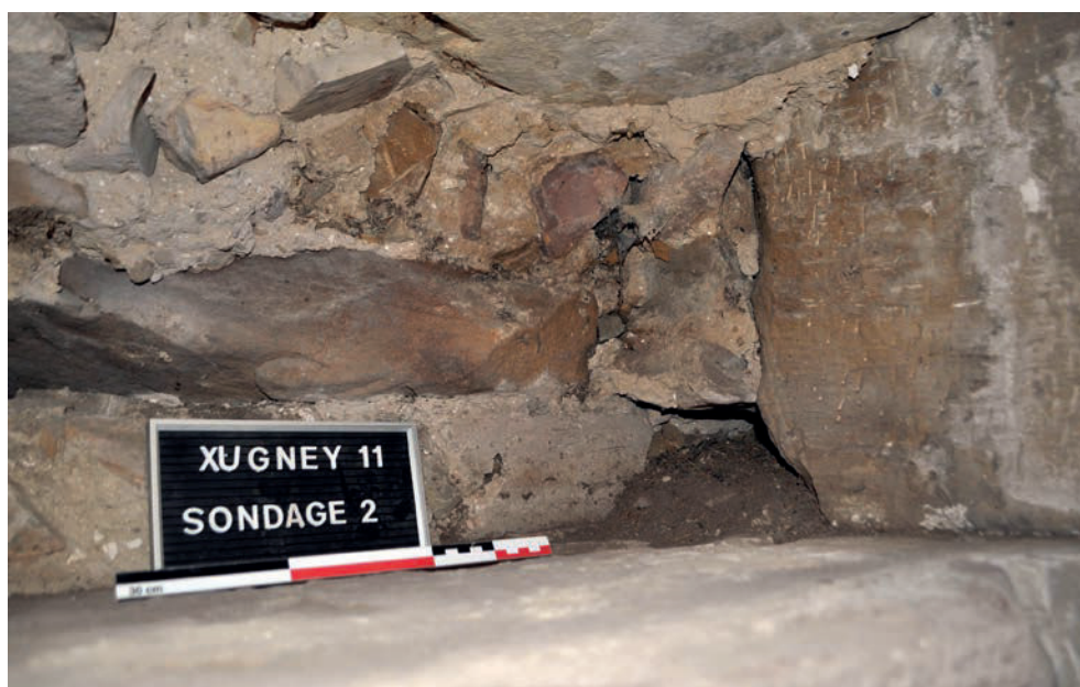
Fig. 105 – Négatif de poutre dans le sondage 2, dans la seconde travée du mur gouttereau sud (cliché Cédric Moulis).
