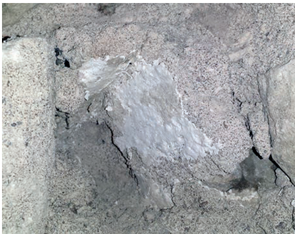
Fig. 11 – Traces d'enduit sous l'intrados (cliché Cédric Moulis).
