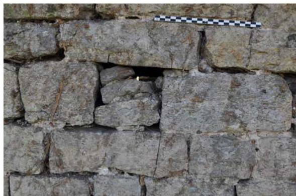
Fig. 69 – Trou de boulin 25C bouché par trois pierres sur l'élévation ouest, UM 2 (cliché Cédric Moulis).
