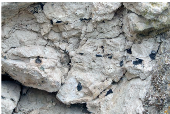
Fig. 26 – Mortier comportant de nombreuses inclusion de charbons de bois (cliché Cédric Moulis).
