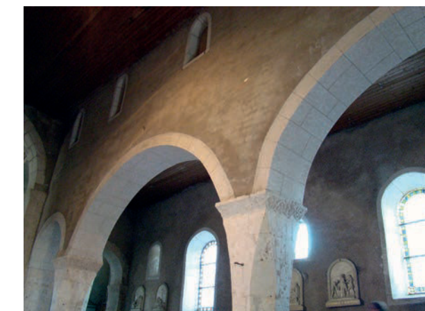
Fig. 5 – Élévation intérieure de la nef de l'église de Vomécourt-sur-Madon (cliché Cédric Moulis).
