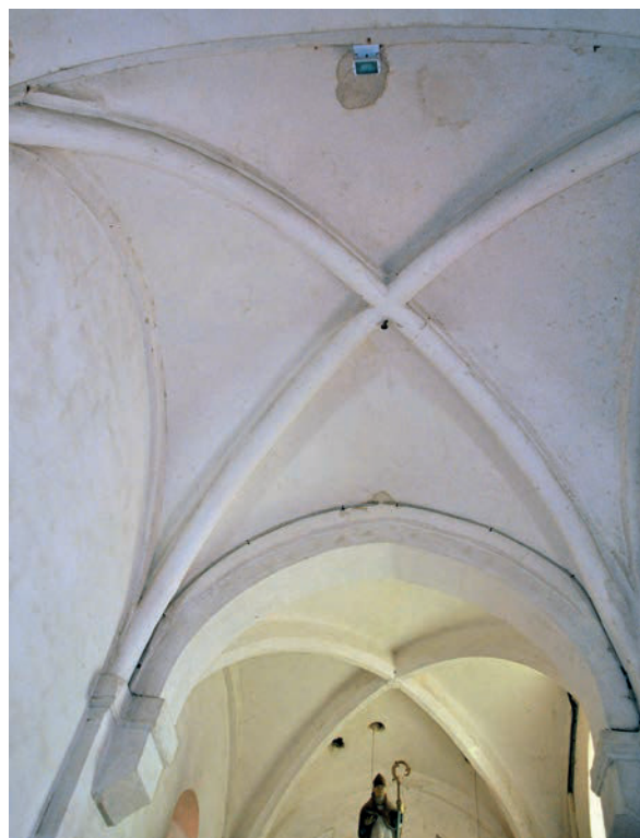
Fig. 14 – Voûte à nervure torique de la première travée du chœur (cliché Cédric Moulis).
