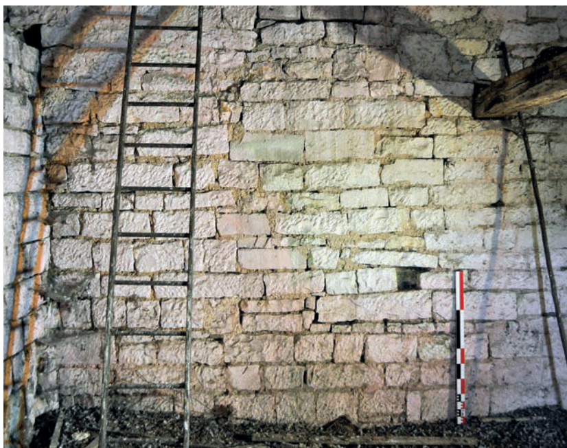
Fig. 28 – Reprise en sous-œuvre (rebouchage ?) dans le parement intérieur nord du premier étage de la tour-chœur. On y remarque l'usage de pierres layées (cliché Cédric Moulis).
