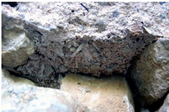
Fig. 32 – Couche de végétaux piégée dans le mortier lors de la reprise des travaux (cliché Cédric Moulis).
