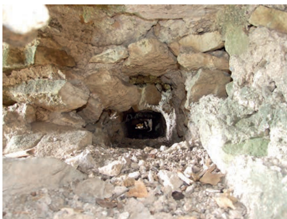
Fig. 10 – Gaine de la solive sur laquelle reposaient les poutres du second étage, dont les gâines sont situées à intervalle régulier sur la gauche (cliché Cédric Moulis).
