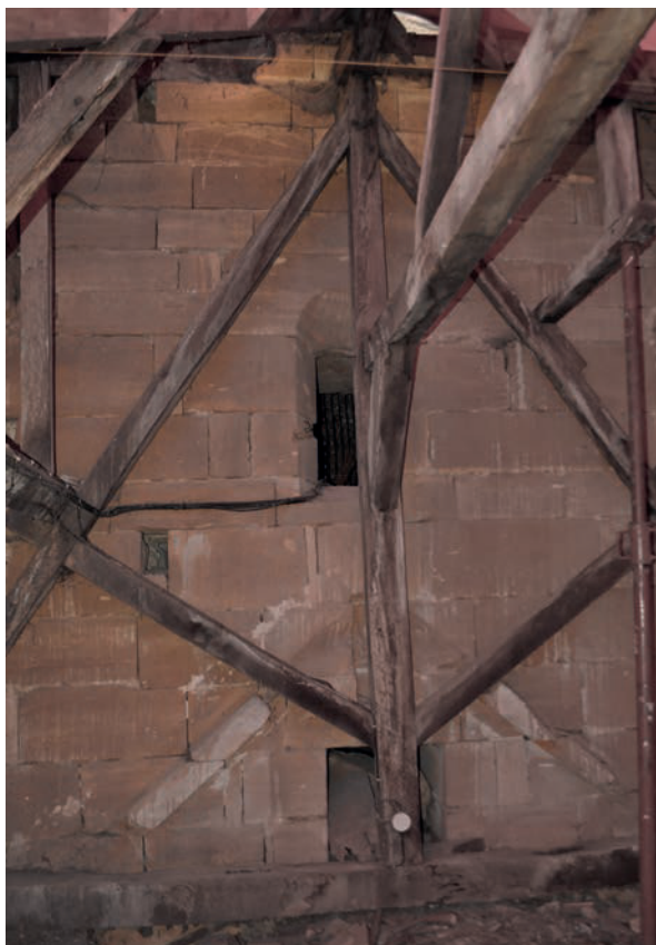
Fig. 19 – Charpente à fermes à chevrons et arbalétriers au-dessus du chœur gothique. On devine la sous-faîtière et la croix-de-saint-André (cliché Cédric Moulis).
