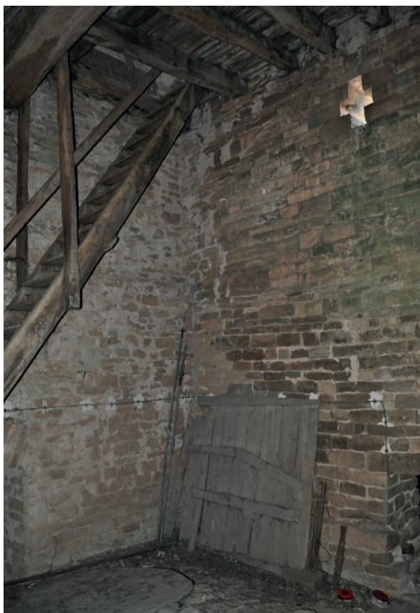
Fig. 38 – Mur nord.XI e siècle du clocher (à droite) et reprise moderne en appareil de moindre qualité (à gauche) (cliché Cédric Moulis).
