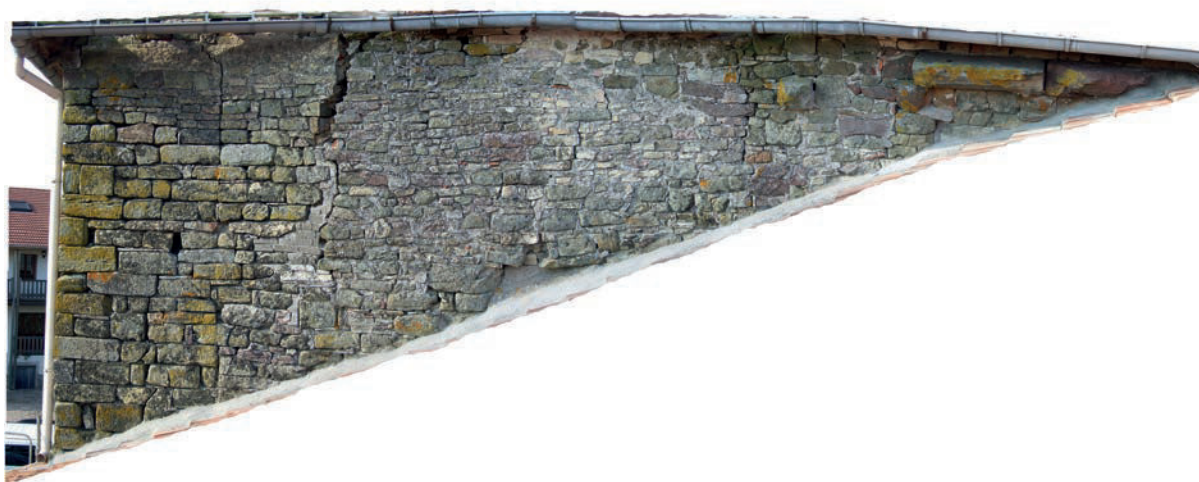
Fig. 15 – Mur gouttereau sud (UM 6), visible depuis le toit de la grange (clichés et montage Cédric Moulis).
