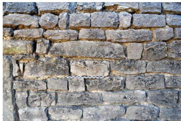
Fig. 63 – Joints creux du parement, UM 1 (cliché Cédric Moulis).
