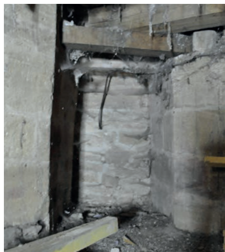
Fig. 5 – Passage bouché entre le troisième niveau du clocher et l'escalier en vis, détruit (cliché Cédric Moulis).
