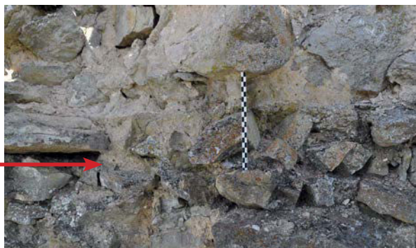
Fig. 51 – Niveau de réglage bien lisible dans le blocage à l'angle des élévations sud et ouest (cliché Cédric Moulis).
