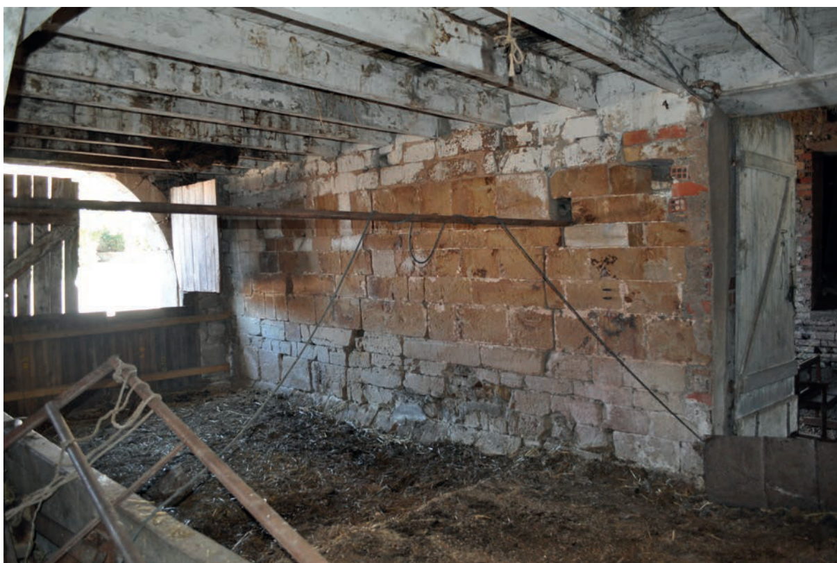
Fig. 13 – Mur gouttereau sud (UM 6), partie est, visible depuis le rez-de-chaussée de la grange (cliché Cédric Moulis).
