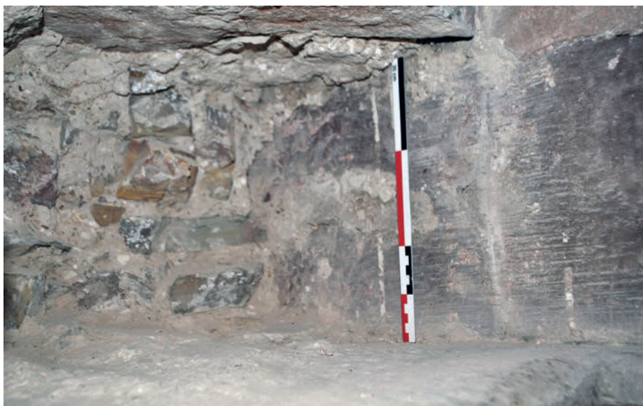
Fig. 106 – Sondage 3 dans le mur pignon de la chapelle (UM 15). On remarque une coulée de lait de chaux (cliché Cédric Moulis).
