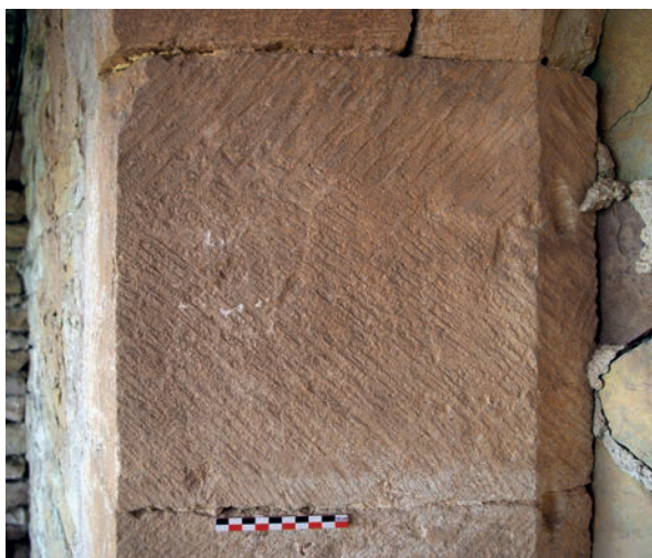
Fig. 15 – Layage observé sur l'ébrasement d'une fenêtre haute de la nef (cliché Cédric Moulis).
