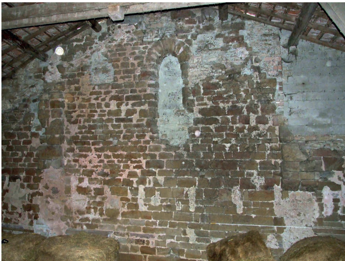
Fig. 12 – Mur gouttereau sud (UM 6), partie visible depuis l'étage de la grange (cliché Cédric Moulis).
