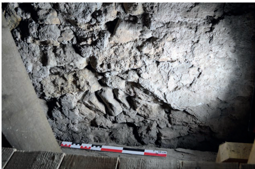
Fig. 36 – Joint d'étanchéité du solin de la nef primitive, contre le clocher (cliché Cédric Moulis).
