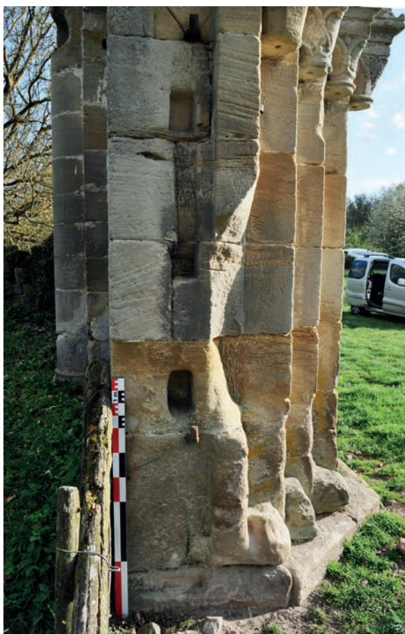
Fig. 6 – Montant droit du portail. On remarque les gonds et les empochements des poutres de verrouillage (cliché Ellia Martin).
