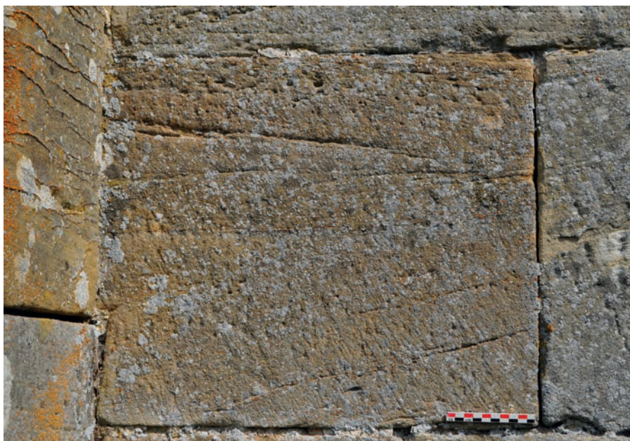
Fig. 30 – Traces de layage oblique sur une pierre du parement de la façade occidentale (cliché Ellia Martin).
