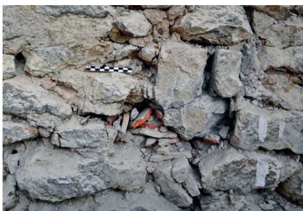
Fig. 30 – Élévation sud, désordres de maçonneries et TCA (cliché Cédric Moulis).
