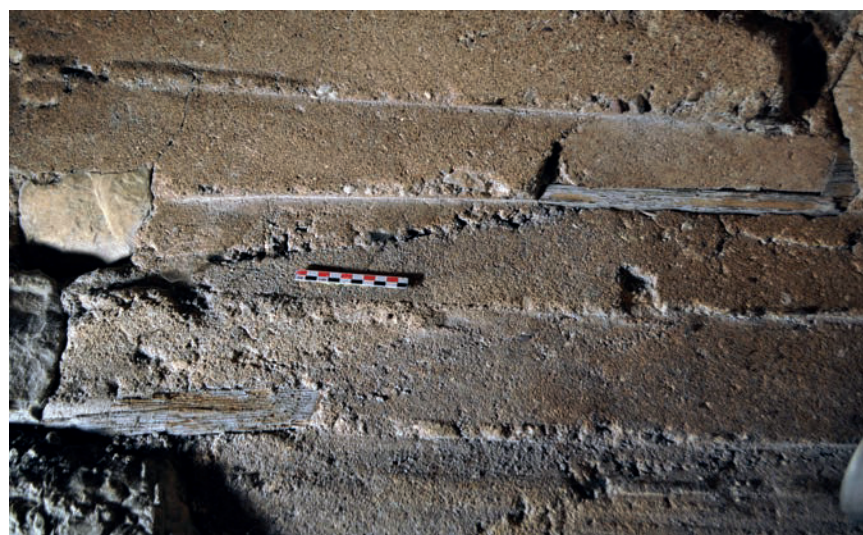
Fig. 58 – Empreintes des couchis visibles sur la voûte de l'escalier et fragments de couchis piégés dans l'enduit (cliché Cédric Moulis).
