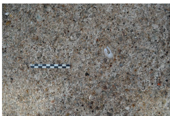
Fig. 45 – Enduit moderne sur le bas-côté nord (cliché Cédric Moulis).
