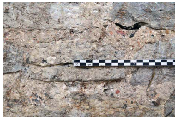
Fig. 65 – Pré-enduit à la base de l'élévation extérieure ouest, UM 6 (cliché Cédric Moulis).
