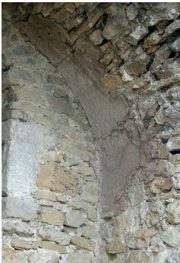
Fig. 34 – Enduit dans la niche d'une fenêtre du second étage (cliché Cédric Moulis).
