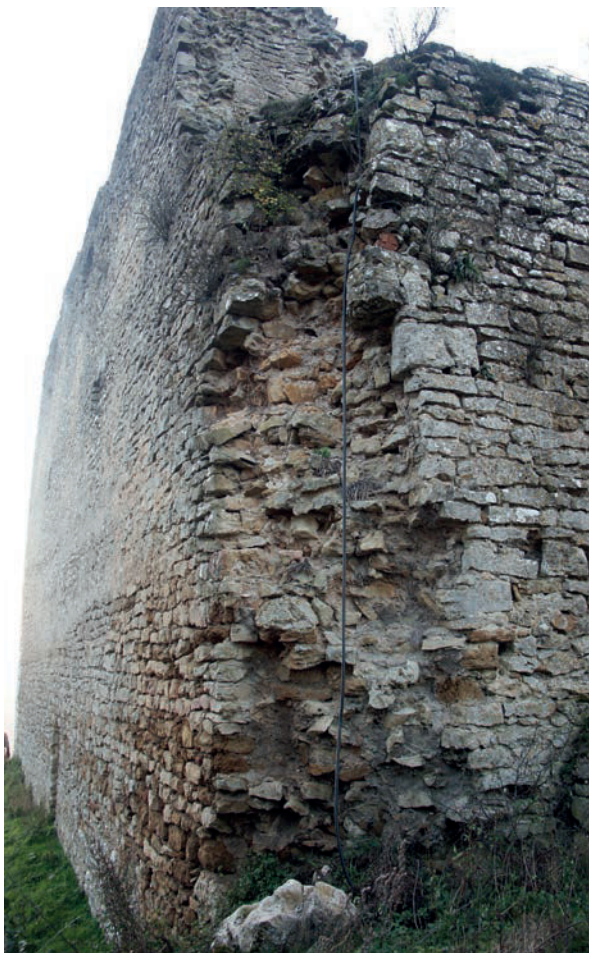
Fig. 28 – Négatif de la chaîne d'angle avant les travaux des années 2000. On distingue encore la disposition en besace (cliché Cédric Moulis).
