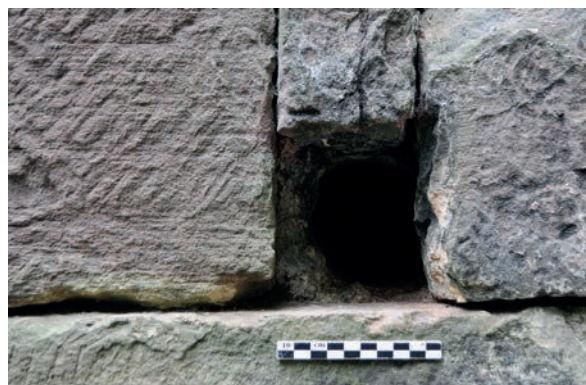
Fig. 20 – Trou de boulin maçonné, avec empreinte du boulin circulaire. Maçonnerie d'angle (cliché Cédric Moulis).
