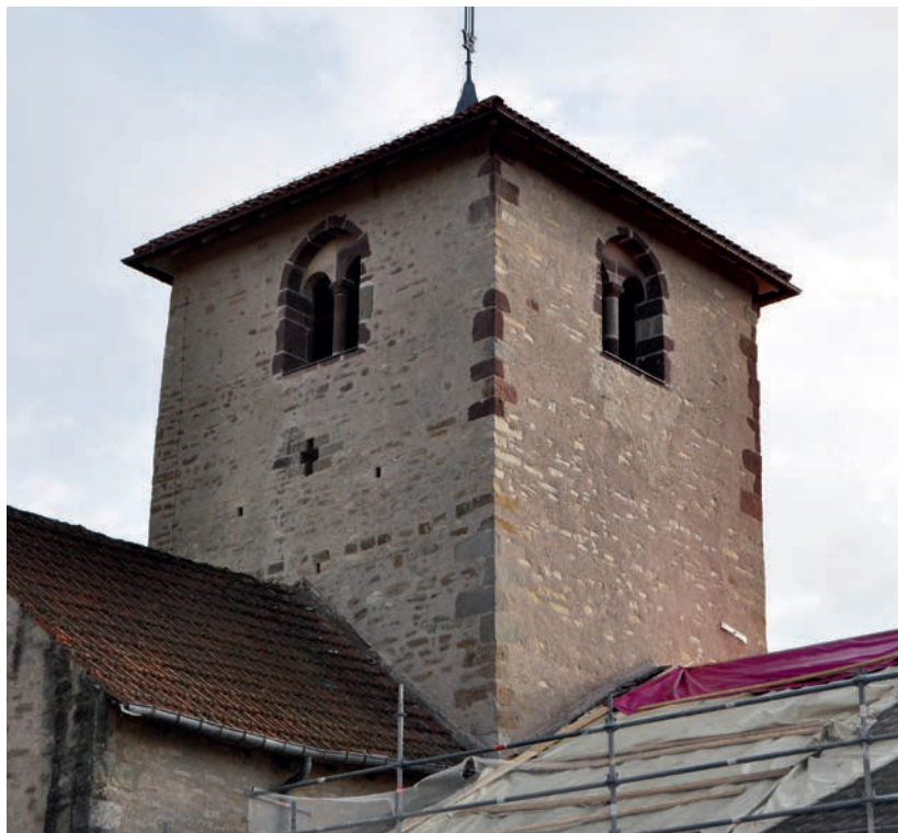
Fig. 63 – Surélévation du clocher visible par les traces du pignon en bâtière (au-dessus de la fenêtre cruciforme) et par l'emploi de grès rose (cliché Cédric Moulis).
