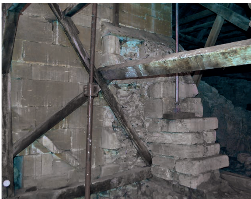
Fig. 3 – Contrefort nord de l'élevation est du clocher, arraché et en partie repris (cliché Cédric Moulis).
