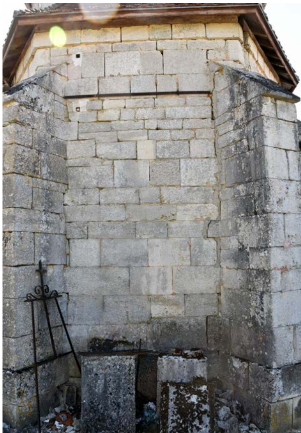
Fig. 28 – Le chaînage de ce pan du chevet de Saudron (52) reprend les différents types de liaisons possibles (cliché Cédric Moulis).
