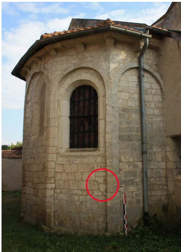
Fig. 26 – Le rythme du parement a été interrompu pour permettre aux pierres du parement et du pilastre de se lier. Chevet de Gézoncourt, 54 (cliché Marion Subtis).
