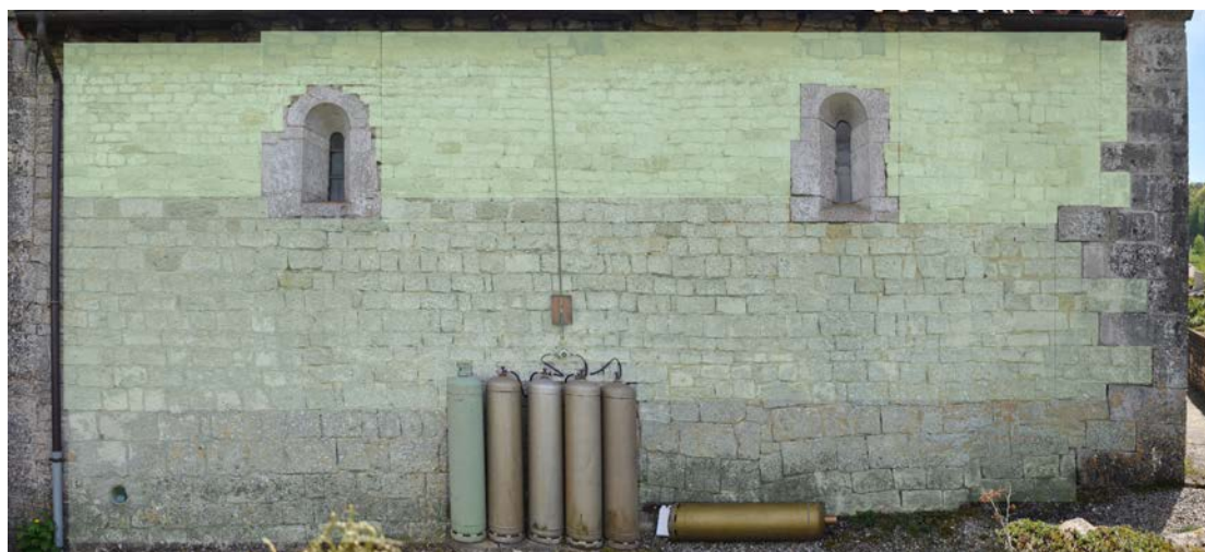
Fig. 9 – Trois SMA bien visibles sur l'élévation du gouttereau nord de l'église de Battigny, 54 (clichés, photoredressement et conception Cédric Moulis).
