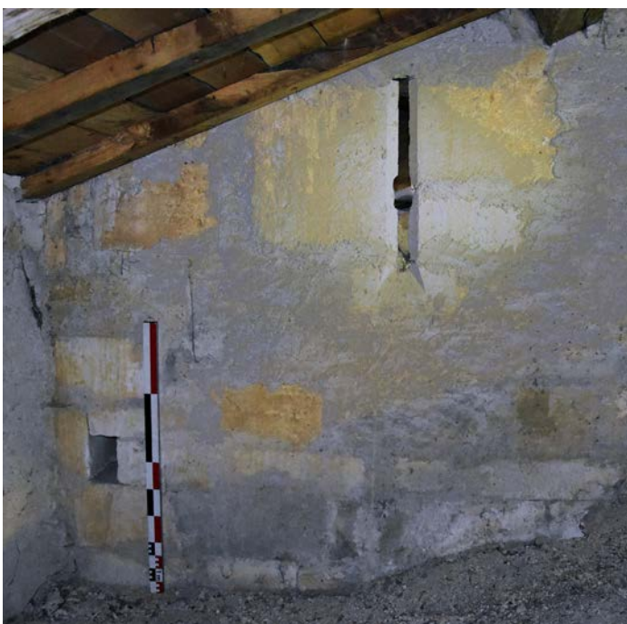
Fig. 10 – Archère à étrier dans le rehaussement des combles du transept nord de l'église d'Allamps (cliché Cédric Moulis).
