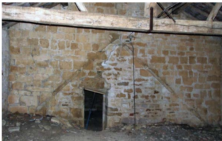
Fig. 22 – Solin de la nef romane de l'église de Vicherey, 88 (cliché Cédric Moulis).
