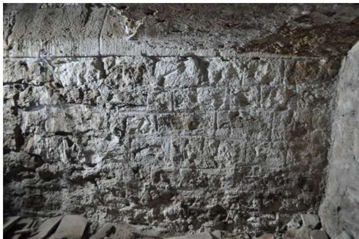
Fig. 19 – Décor de joints tirés au fer larges, base extérieure du prieuré de Blanzey, 54 (cliché Cédric Moulis).
