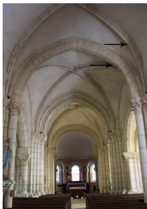
Fig. 54 – Déformation des arcs et voûtes dus au glissement vers la pente naturelle du relief, église d'Allamps, 54 (cliché Marion Subts).
