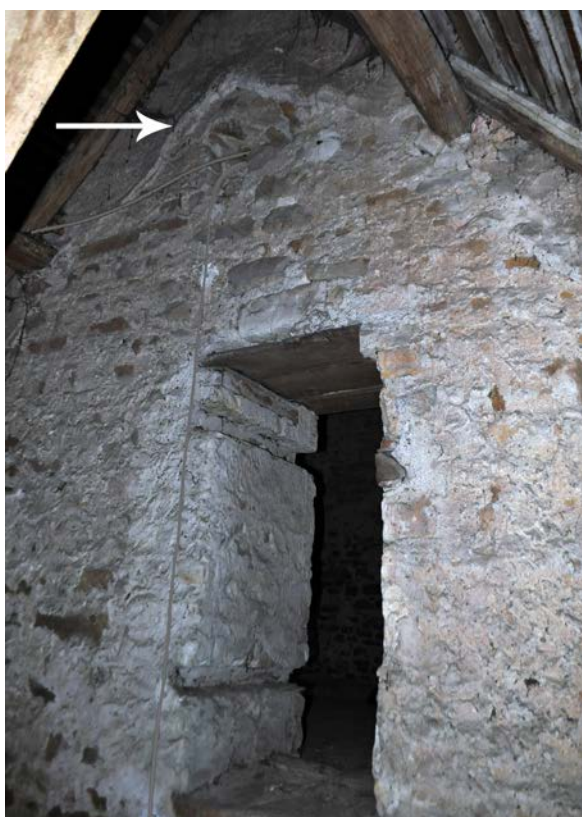
Fig. 21 – Joint d'étanchéité sans solin de pierre, église de Vaudeville, 54 (cliché Cédric Moulis).
