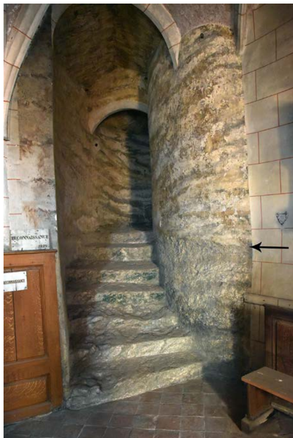
Fig. 14 – Un des escaliers menant à la crypte de Dieulouard (54), taillé dans le substrat calcaire (cliché Cédric Moulis).
