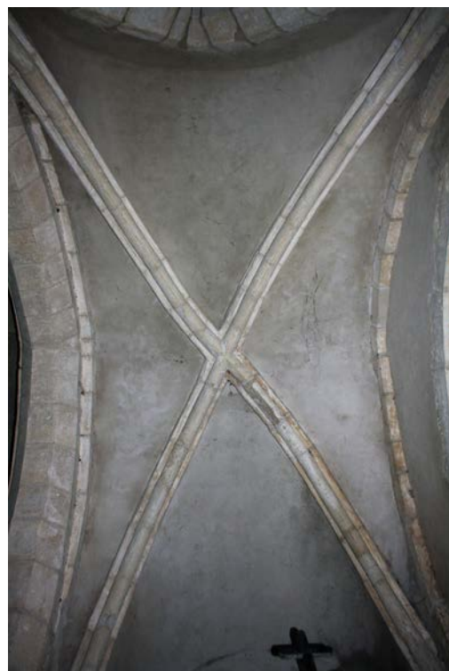
Fig. 52 – Croisée d'ogives moulurée déformée lors de sa mise en tension, église d'Allamps, 54 (cliché Marion Subts).
