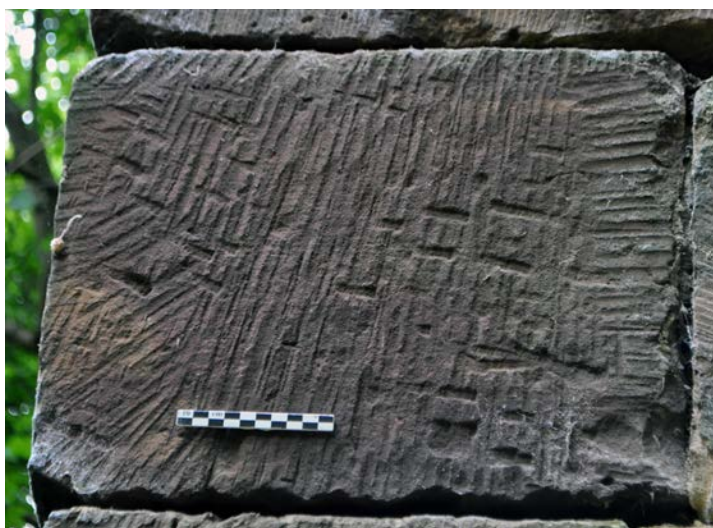
Fig. 23 – Layage à traces larges sur le château de Romont, 88 (cliché Cédric Moulis).
