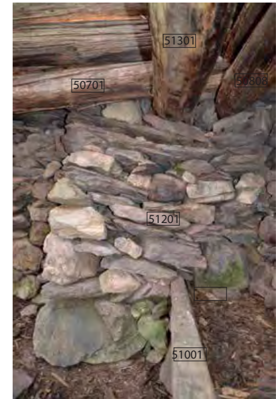
Figure 33 : Pilier 51201, vue de face. Cliché de V. Labbas, 2012
