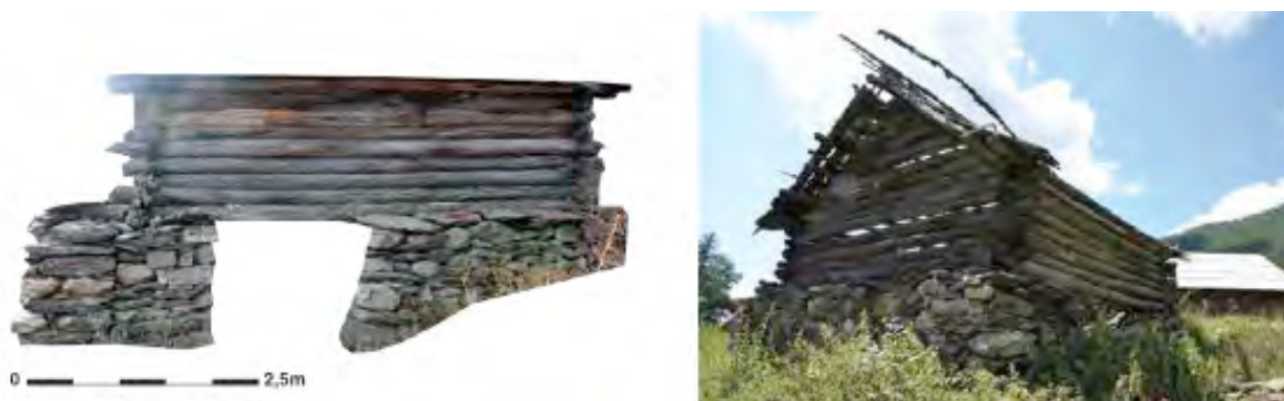
Figure 153 : Deux exemples de granges observées sur le site de Rougios. A gauche, photomontage du gouttereau nord du bâtiment RG 500 (début XIX e siècle) et à droite une autre grange présentant les mêmes caractéristiques de montage. Cl. et DAO de V. Labbas.
