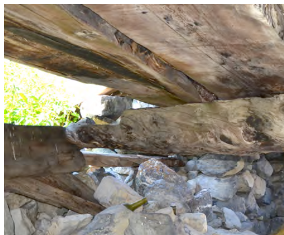
Figure 159 : Poutre de section circulaire du bâtiment RUS 200 (Vol.3, Saint Etienne-de-Tinée) dans le vallon de Roya. Une seule encoche à mi-bois permet l'emboîtement avec la sablière posée au dessus. Cl. V. Labbas.
