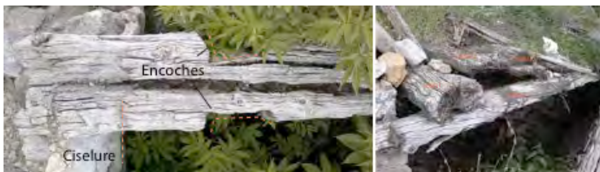
Figure 174 : Détail de mailles d'élévation réemployées en poutre de plafond (à gauche) et en lambourdes de plancher (à droite) dans le bâtiment BLA 300 (Blainon, vallon de Roya). Cl. et DAO de V. Labbas.
