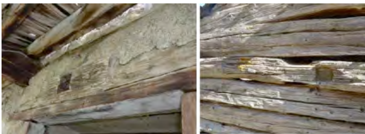
Figure 175 : Deux exemples de sablières réemployées : Bâtiment CR 100 (Champrichard, Allos), à gauche, une ancienne sablière de charpente réemployée en sablière de toiture. A droite, une sablière-formant-seuil ou linteau réemployée en maille d'élévation dans la grange CBO 500 (Bousieyas, Saint-Dalmas-le-Selvage). Cl. de V. Labbas.
