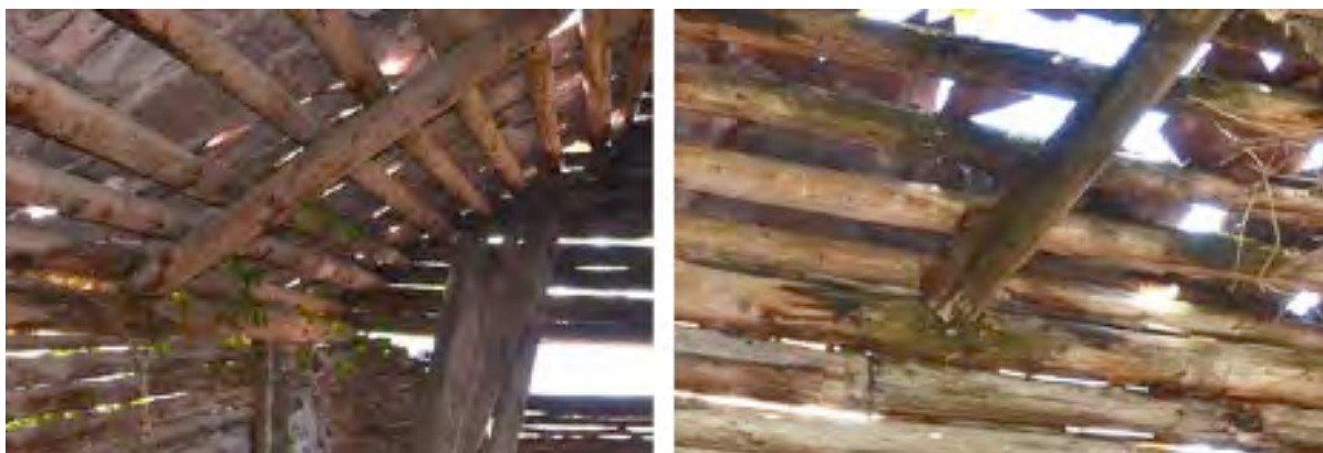
Figure 163 : Détails d'arbalétriers dans une grange du village de Roure (à gauche) et dans la grange RG 500 à Rougios (commune de Roure, à droite). Cl. de V. Labbas.
