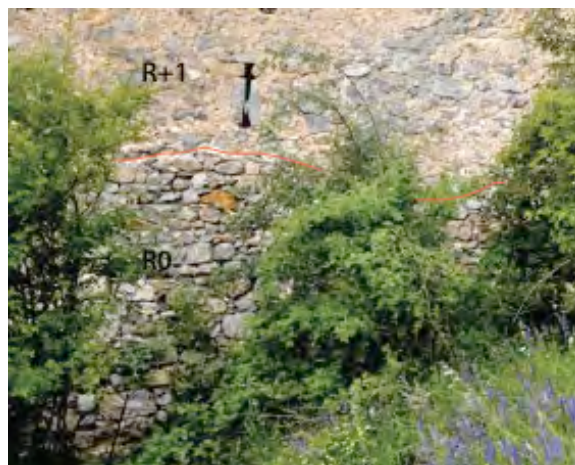
Figure 114 : Rupture de maçonnerie entre le R0 et le R+1 (mur oriental 1102). Cl. V. Labbas
