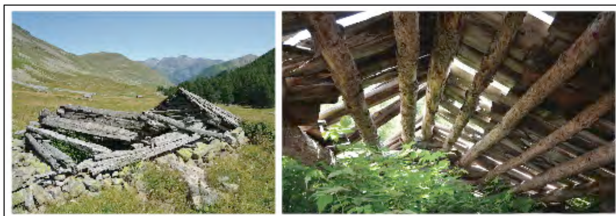
Figure 91 : Le bâtiment CBO 400, vue de l'ouest et vue intérieure de la toiture. Cl. V.L.
