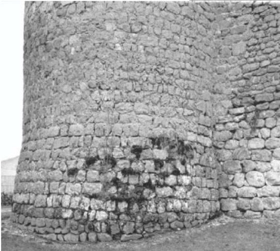
fig. 844. Détail du talus de la tour circulaire. Dossier de l'Inventaire. Usson-le-château. Usson-en-Forez.
