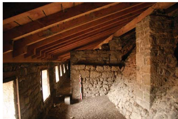
fig. 712. Vue de la coursive dans les combles sur le chemin de ronde sud. Saint-Paulien.
