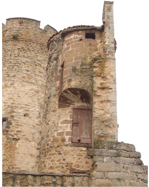
fig. 761. Détail du passage sur trompe, flanc est de la tour d'escalier. Mercoeur.
