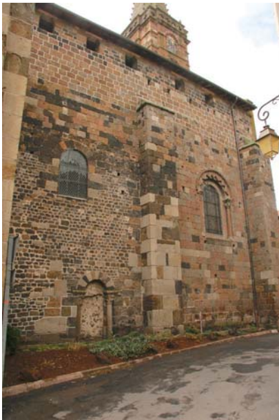
fig. 710. Vue du chemin de ronde restauré sur le mur gouttereau nord. Saint-Paulien.
