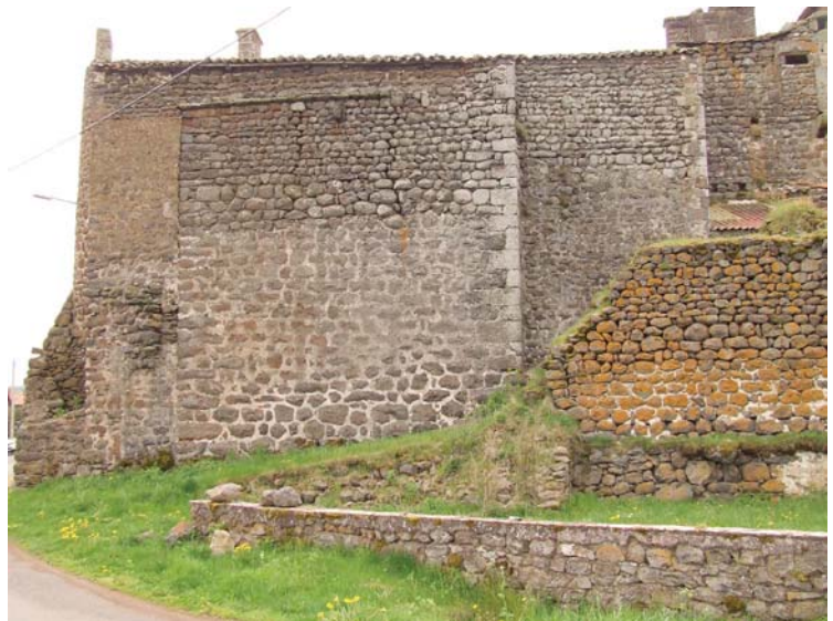
fig. 808. Vue du flanc nord : extrémité est : dernier corps de logis aveugle moderne, comportant une tour en façade sur cour. Séneujols.
