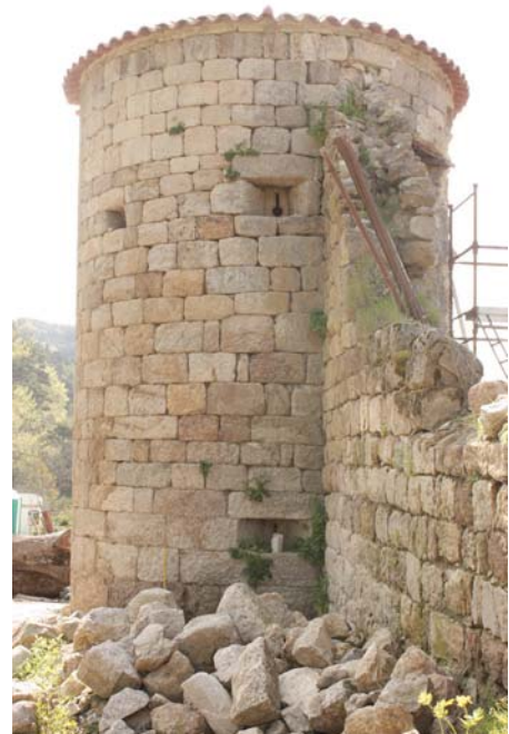
fig. 793. Vue des ouvertures de tirs flanquant le mur nord de Soubrey. Salettes.
