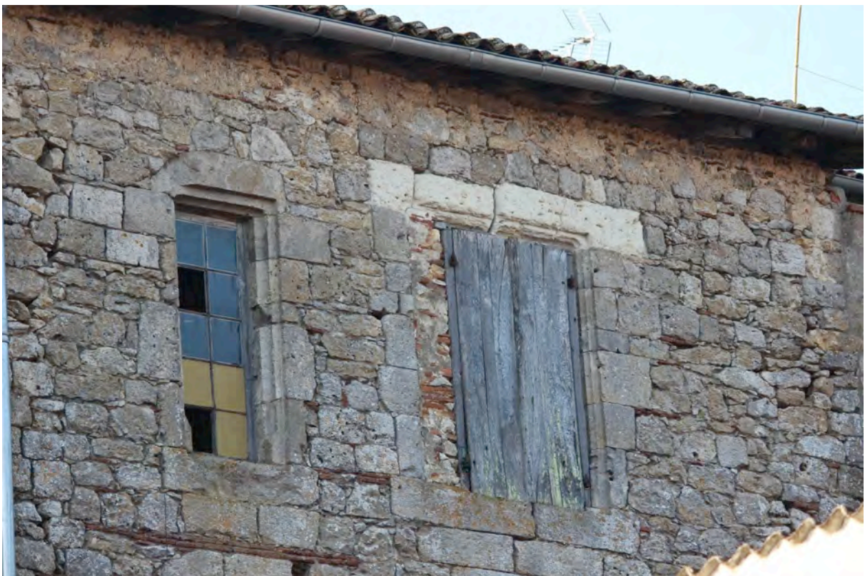
Fig. 9-118 – Montréal, maison (parcelle BM 210), élévation nord, détail d'une demi-croisée et d'une croisée dont la mouluration est à double cavet renversé (remaniée).
