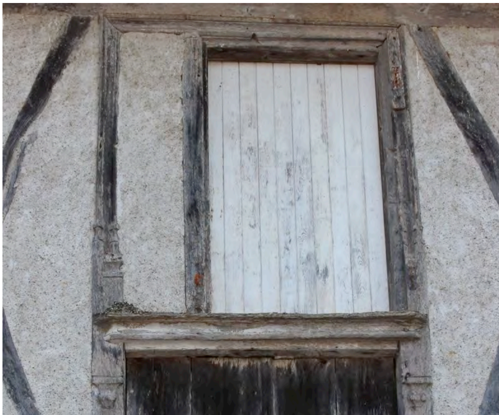
Fig. 9-58 – Touget, maison (parcelle C 52), élévation nord, détail de la croisée du premier étage.
