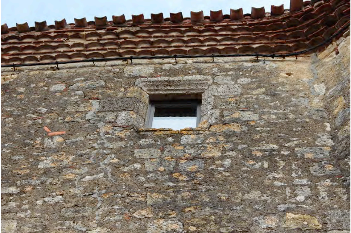
Fig. 9-119 – Montréal, maison (parcelle BM 213), élévation ouest, détail d'une fenêtre à triple cavet renversé.
