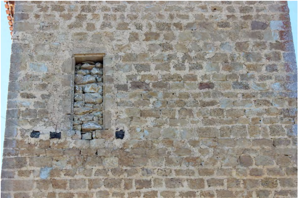
Fig. 8-58 – Bassoues, tour d'angle, face orientale, porte insérée dans la maçonnerie postérieurement à la fin du Moyen Âge.
