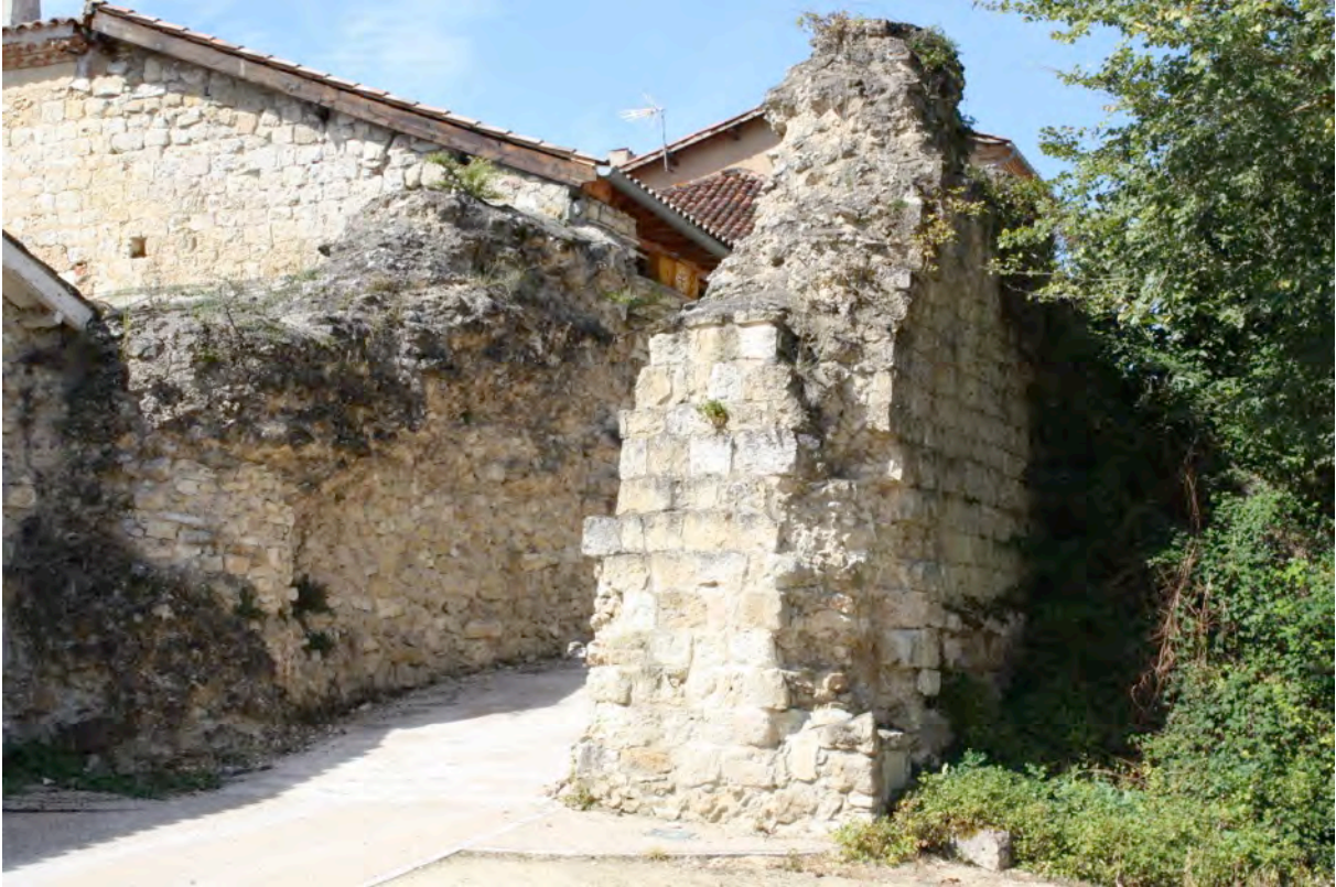
Fig. 6-79 – Saint-Paul-de-Baïse, vestiges de la porte, vue depuis le nord-est. Le parement du mur de gauche est tombé laissant le blocage visible sur l'ensemble du mur.
