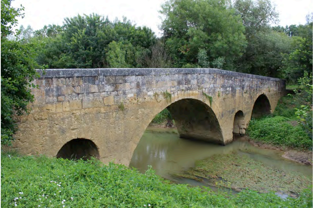
Fig. 3-15 – Pont d'Artigues, sur l'Osse, entre les communes de Beaumont et Larressingle, amont, vue depuis le sud-ouest. Ce pont correspond très probablement à celui dont il est question dans les comptes consulaires de Montréal au XV e siècle. NB : ce cliché a été pris avant les importants travaux de restauration de l'hiver 2016-2017 qui ont fortement modifié l'aspect général du site et sans doute détruit des vestiges archéologiques tant sur le pont lui-même qu'à ses abords.
