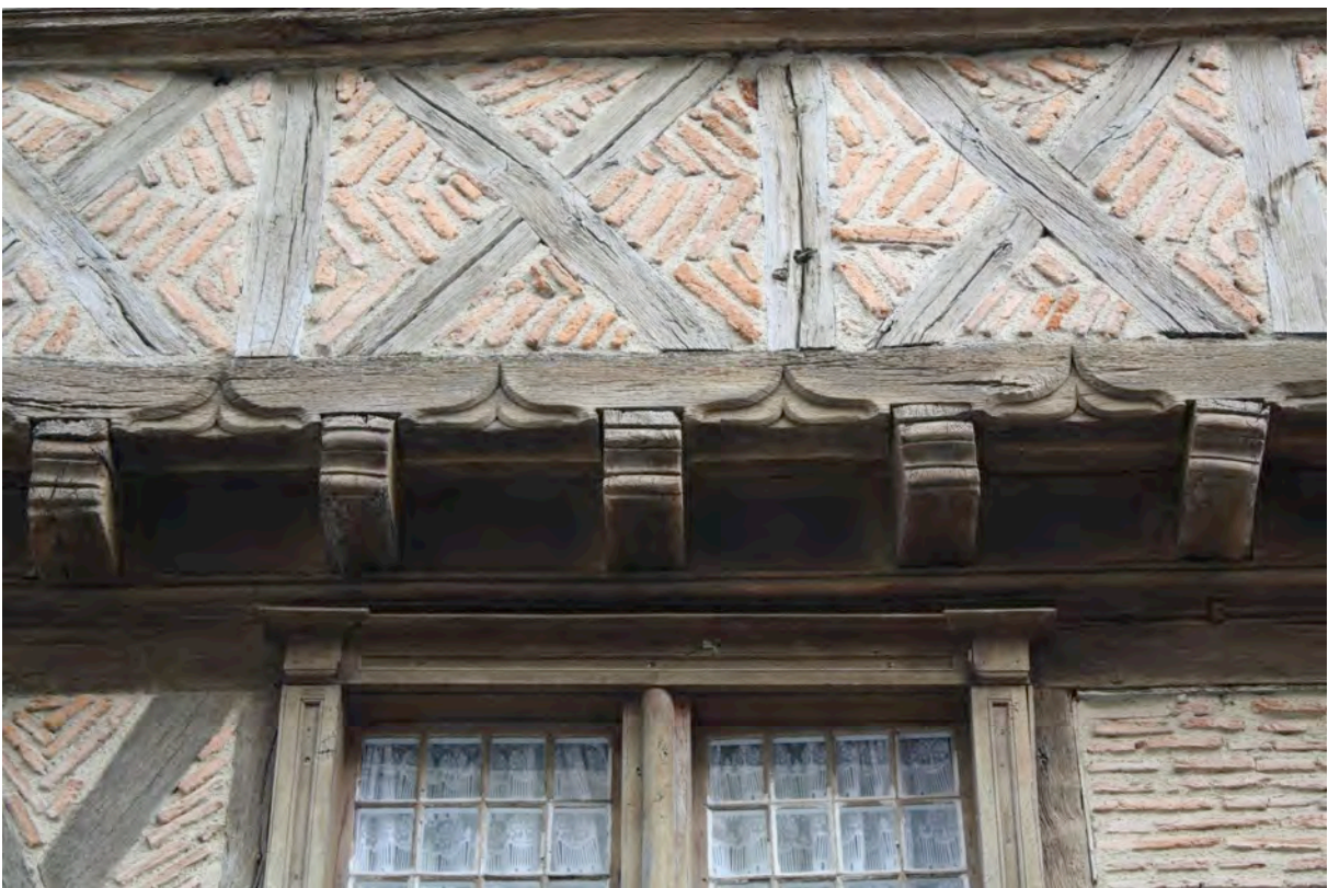
Fig. 9-93 – Jegun, maison (parcelle AT 250), détail des abouts de solives du deuxième étage.
