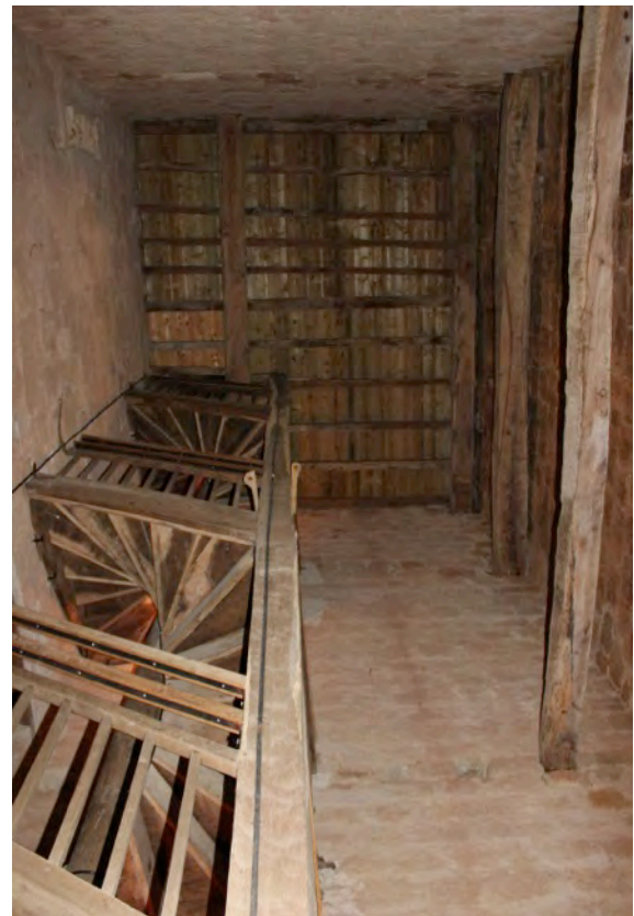
Fig. 8-38 – Sabazan, vue intérieure des trois premiers niveaux de la tour depuis le rez-de-chaussée.
