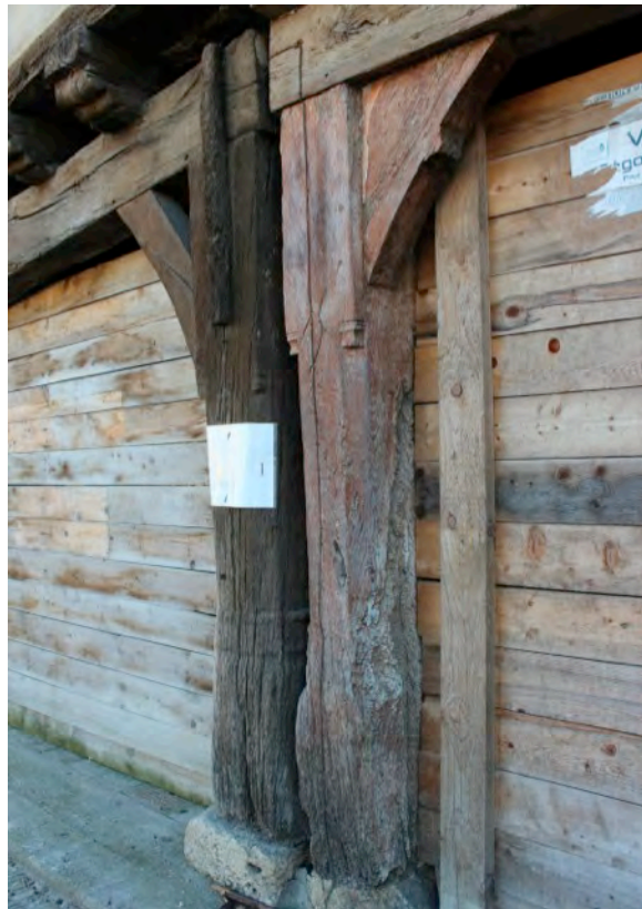
Fig. 9-143 – Cologne, maisons (parcelles AA 227 et 228), détail des poteaux portant les couverts sur lesquels reposent les sablières de plancher, vue depuis le nord-ouest.
