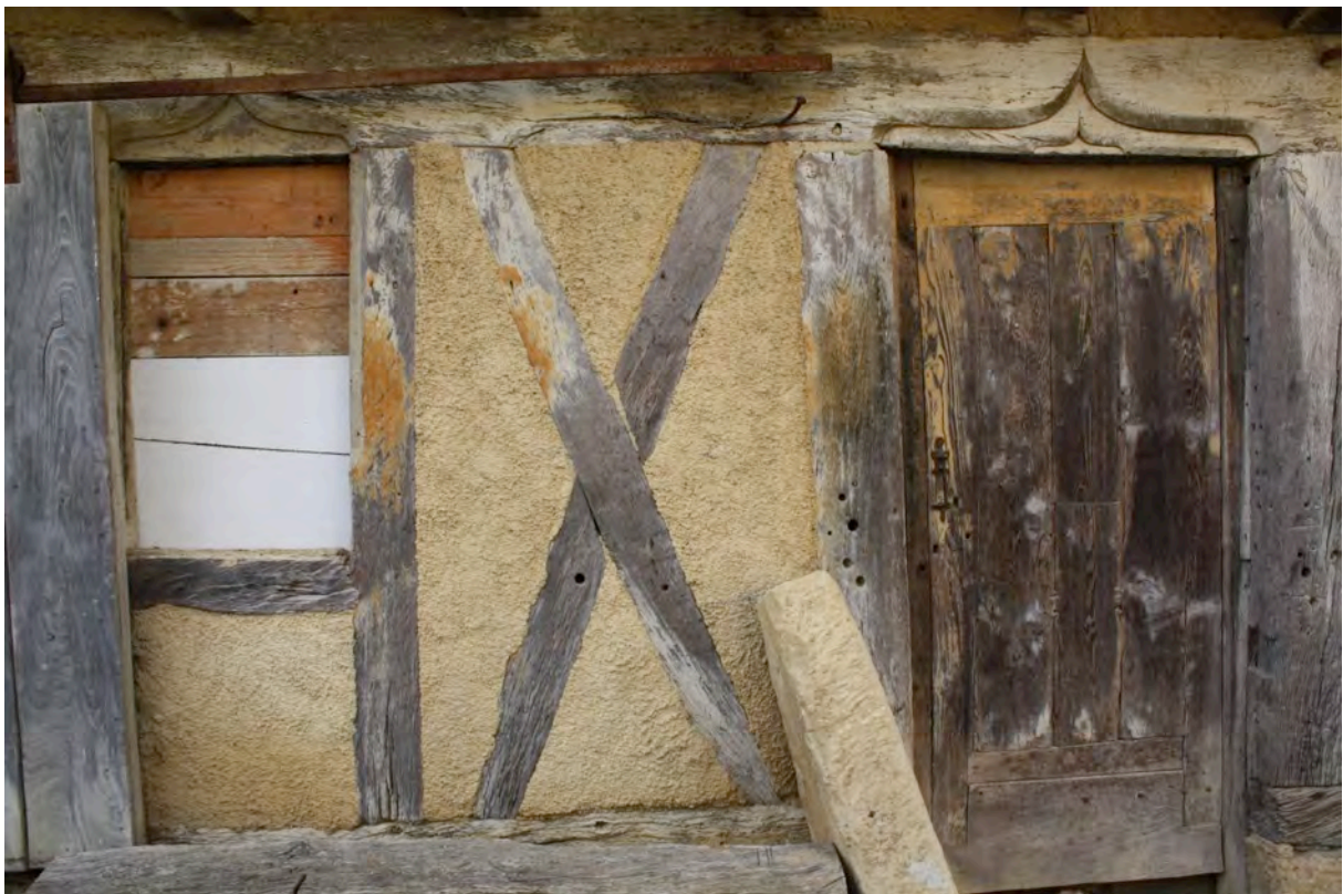
Fig. 9-56 – Montesquiou, maison (parcelle AB 154), façade est, détail des portes à accolades sculptées du rez-de-chaussée.
