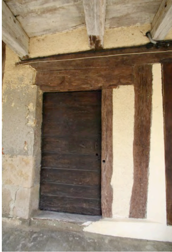
Fig. 9-96 – Gimbrède, maison (parcelle AO 46), ouverture mixte à accolades en rez-de-chaussée, vue depuis le nord.
