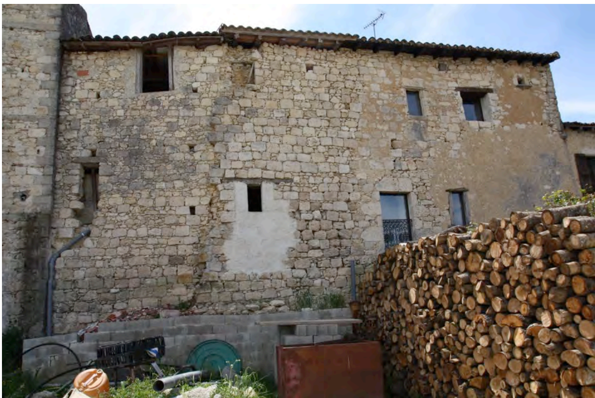
Fig. 8-14 – Plieux, vestiges du mur d'enceinte formant le mur arrière des maisons sur le front nord du village, vue depuis le nord.
