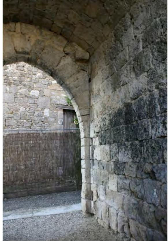
Fig. 6-60 – Lagarde, couloir de la tour-porte, détail des corbeaux empêchant que la porte soit dégoncée.
