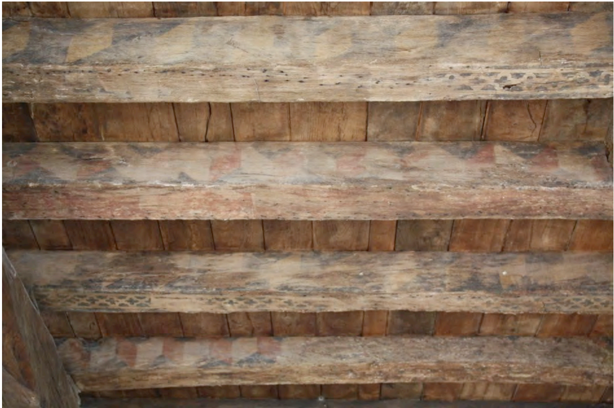
Fig. 9-147 – Montréal, couverts de l'actuelle mairie (parcelles BM 277 et 278), détail des solives peintes.
