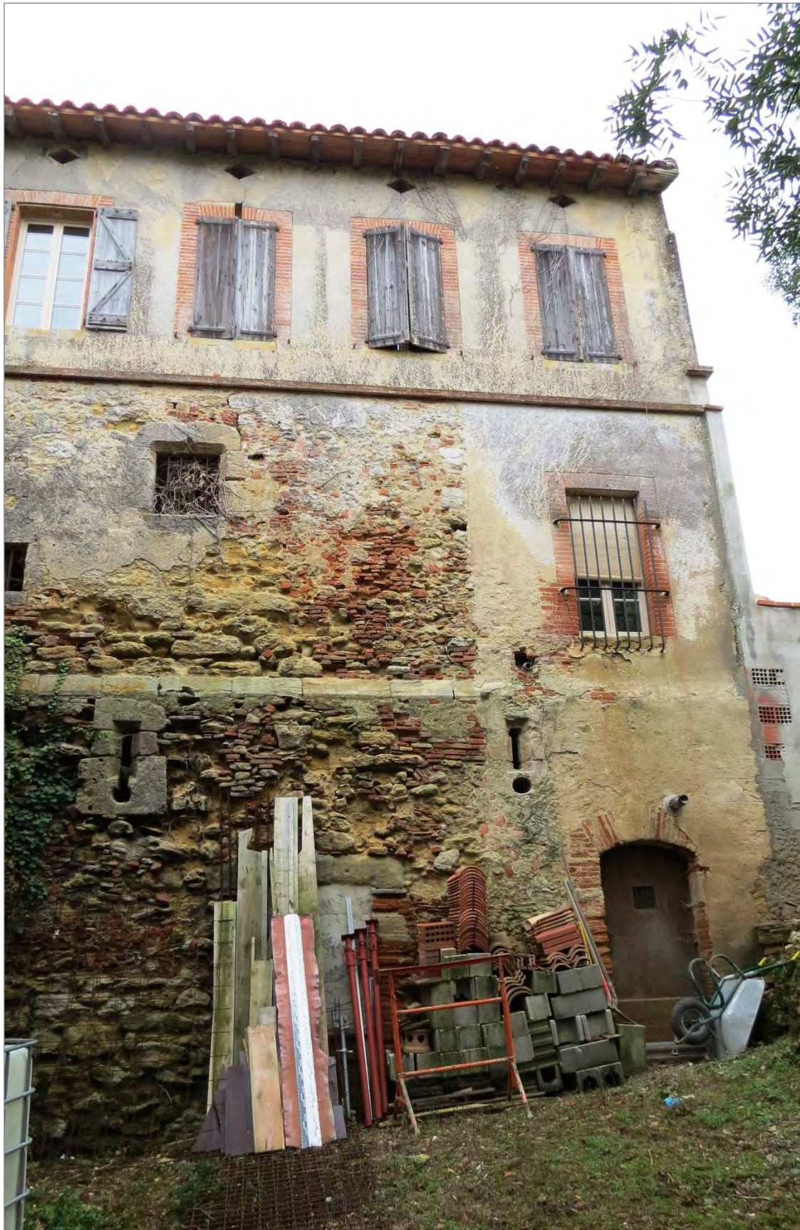
Fig. 136 : Façade nord de la commanderie : embrasures de tir pour armes à feu (XVI e siècle ?) (Cliché : C. Lacroix, 2013).
