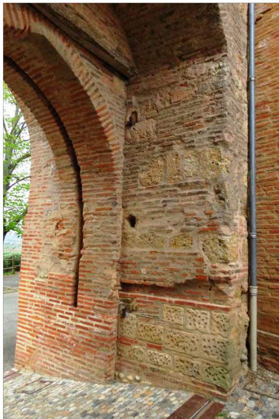
Fig. 83 : Clermont-le-Fort, détail de la paroi intérieure ouest de la tour-porte (Cliché : C. Lacroix, 2016).
