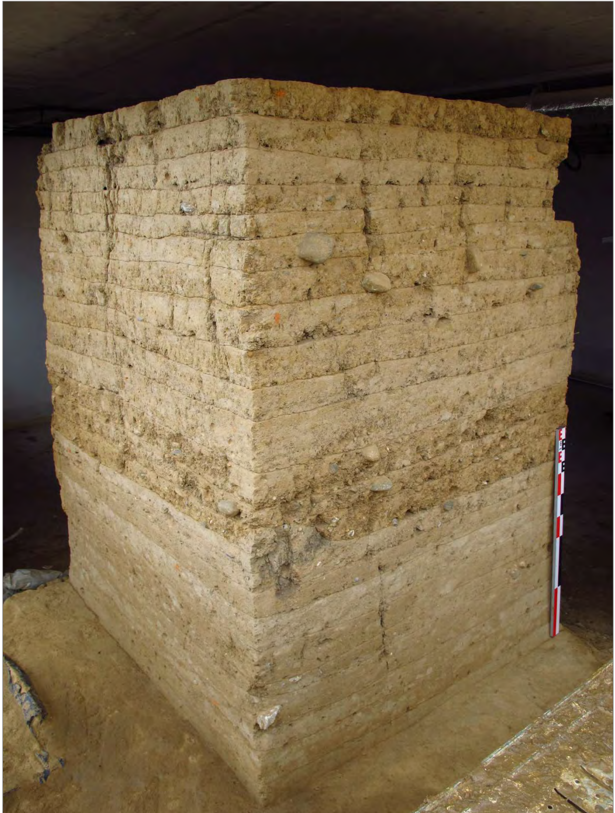
Fig. 108 : Vue depuis le Nord-Est du rempart médiéval conservé par la mairie (Cliché : P. Pisani, 2013, SATM).
