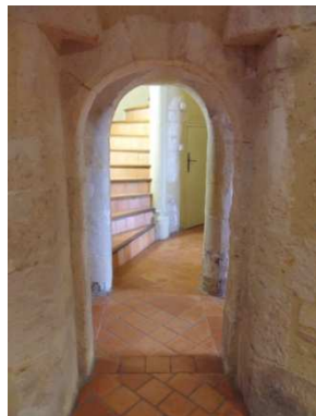
Figure 306 : Vestibule à Haut Éclair à Nogent-le-Bernard
