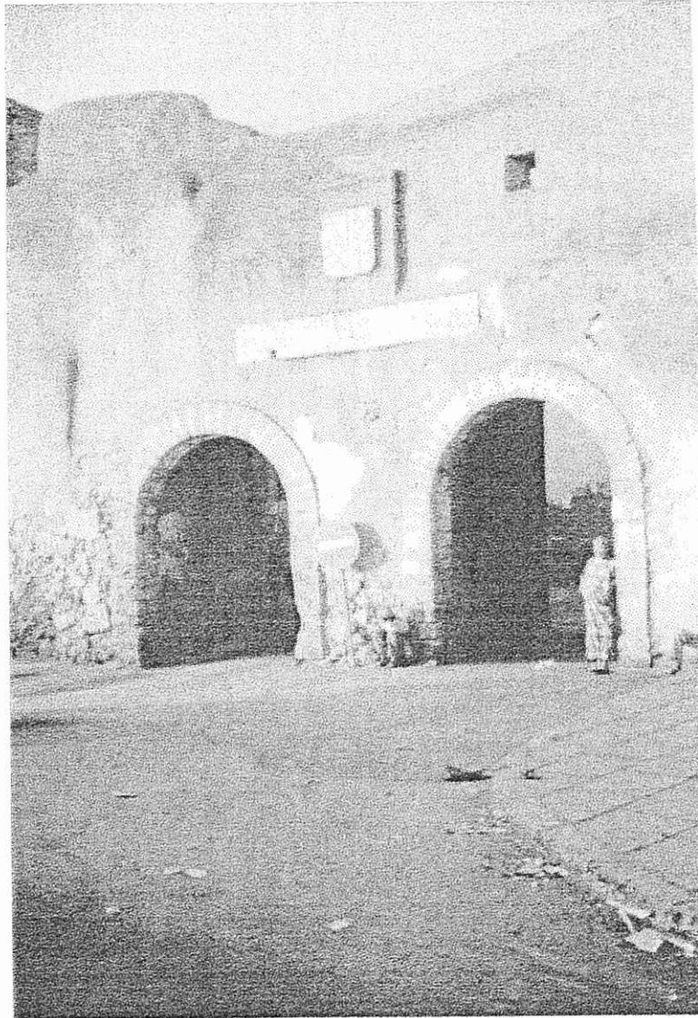
Photographie n° 48 - El Jadida : la porte "principale", en mauvais état d'entretien, malgré de récents et fréquents recrépissages.
