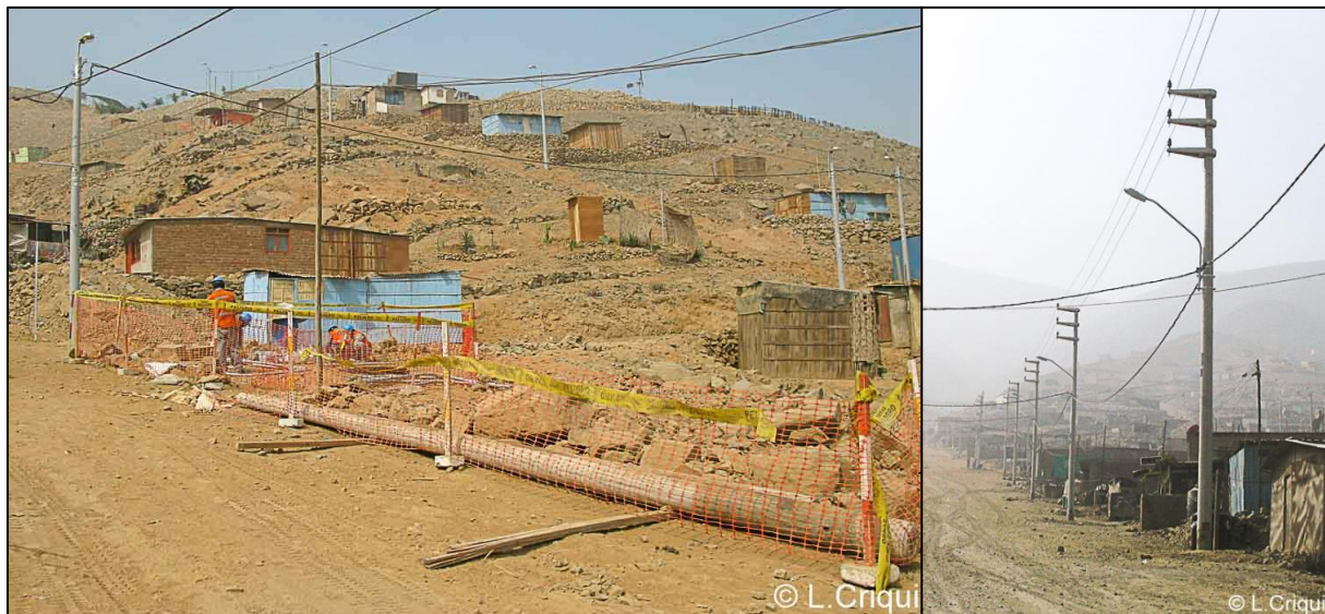
Photo 97/L.  lectrification avant construction compl te
