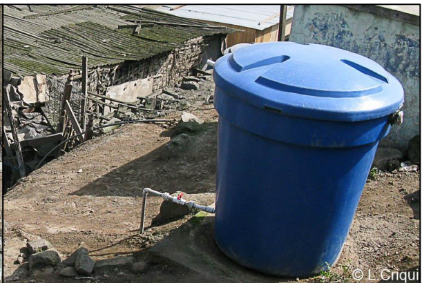
Photo 44/L. Plomberie domiciliaire extérieure (Lima, Comas, Collique, 29/08/2012)
