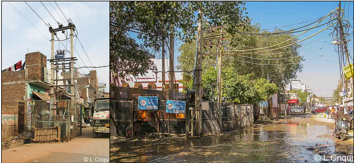
Photo 69/D. Transformateur empiétant sur la route
