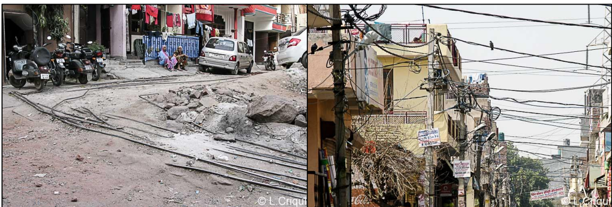
Photo 12/D. Réseau d'eau clandestin (Delhi, Sheikh Sarai, 10/03/2013)
