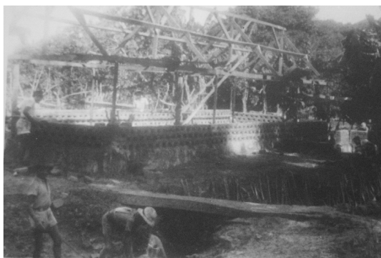
ER de Farafangana, pose des enduits, 1948 Source : ARM G143, photo de René Pallissière
