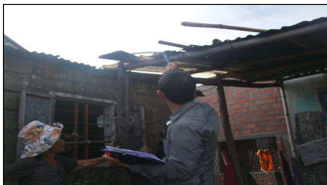
Photographie 6.8. Exemple de dégât matériel causé par le typhon en 2009 (Photographie : Nam, 2012)
