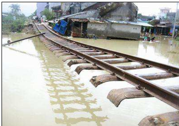
Photographie 6.4. Endommagements sévères de l'unique voie ferrée, dans le quartier de Dong Da (9h, le 4 novembre 2009) (Source : http://www.BinhDinhffc.com )
