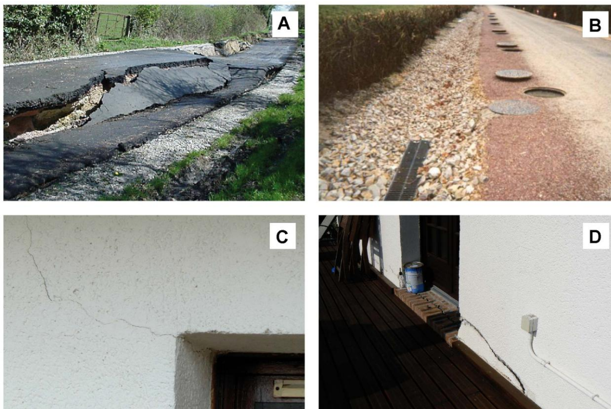
(A) état de la route en mai 2001 suite au déclenchement du glissement à Lécaude (TP-Géo, 2001) ; (B) restauration de la route, remblai de l’escarpement principal et pose de drains siphon (TP-Géo, 2002) ; (C) et (D) illustrations de la fissuration progressive de l’habitation directement exposée au glissement (mars 2010)
