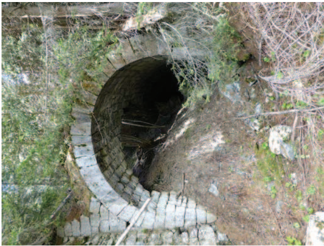
Galerie éboulée sur le versant nord, sur les hauteurs de Lanslebourg.
