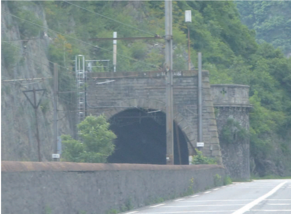
Photographie 32. Entrée du tunnel de la Madeleine (côté Aix-les-Bains) entre La Chambre et Saint-Jean-de-Maurienne (E. Cottet Dumoulin, mai 2013).
