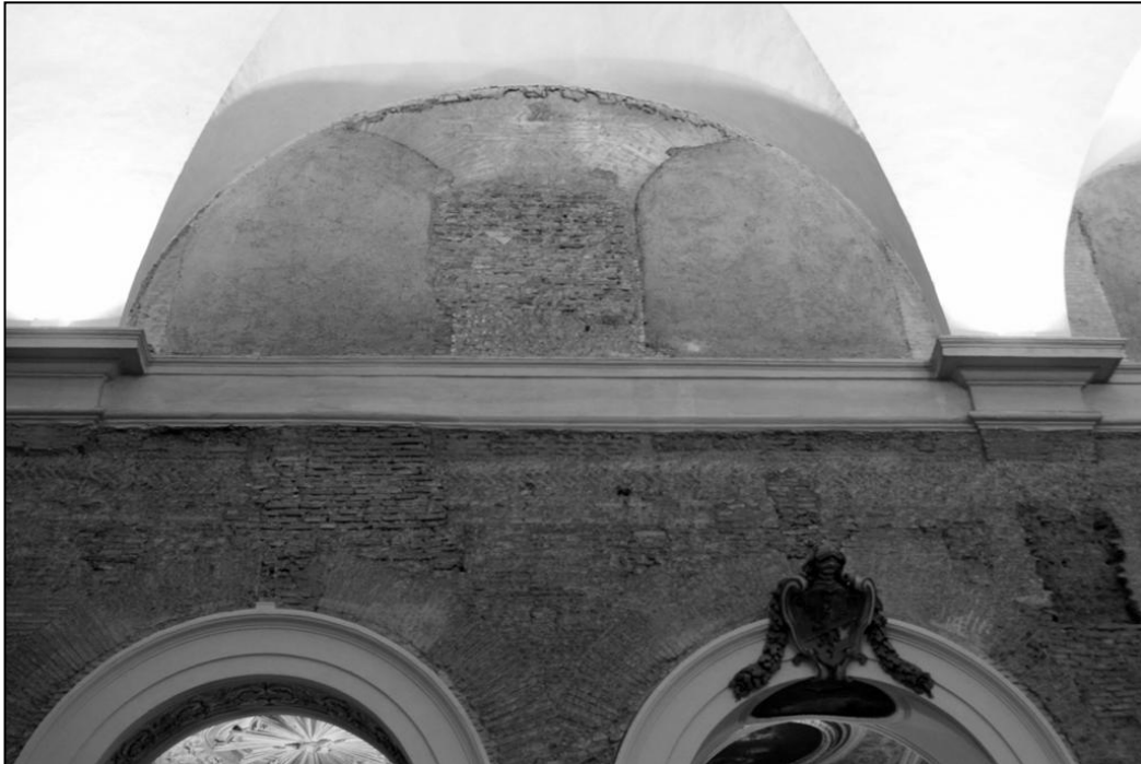
Figure 112 : Fenêtres hautes de la basilica thermanum encore visibles dans la nef principale de l'église (cliché A. L. Foulché)
