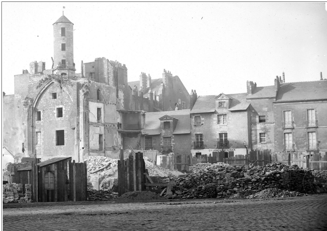
Illustration 126 : Démolition de la chapelle de la Collégiale, [1866] : photographie (Collection Société archéologique et historique de Nantes et de la Loire-Atlantique, tous droits réservés ; fonds Soreau BCB 043) 203
