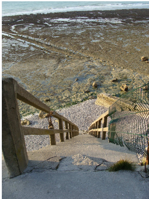
Photo 15: Escalier endommagé à Eletot (l'accès à cet escalier est normalement interdit)
