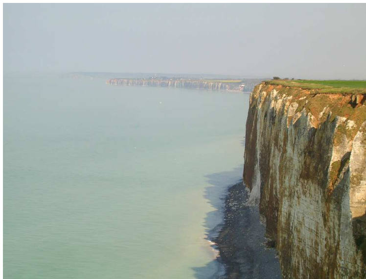
Photo 31 : Vue panoramique depuis le GR, sur les falaises de Saint-Valéry-en-Caux. Au premier plan, on aperçoit les traces d'un éboulement récent.
