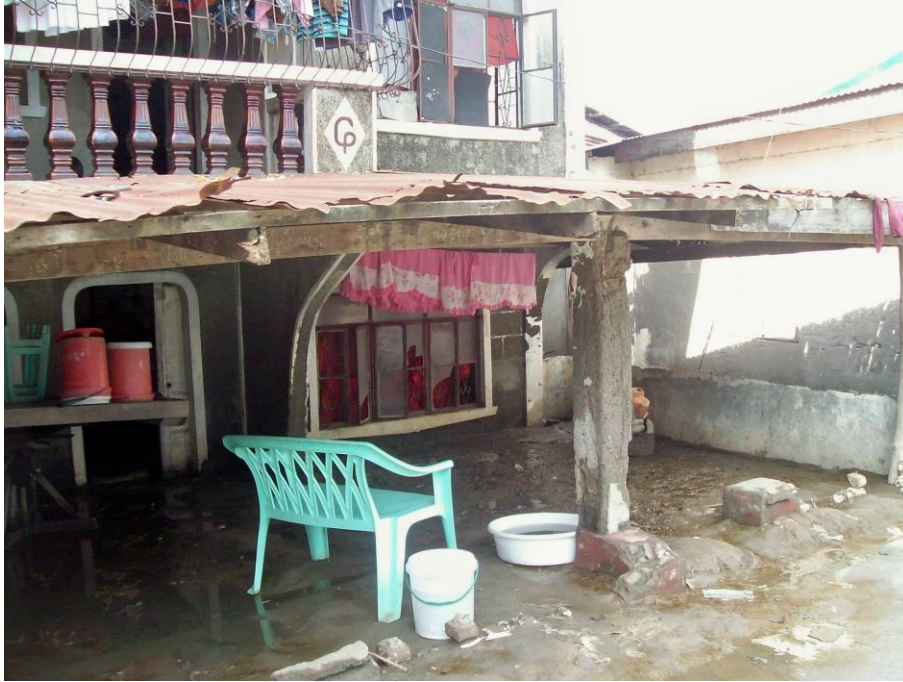
Figure 6-24 - Conséquence de la subsidence sur le bâti. On constate l'enfoncement de la maison par la hauteur de la taille de la porte et la hauteur de la fenêtre par rapport au sol (Sapang Kawayan, Masantol).
