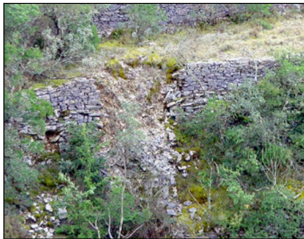
Photo 7.5. Mur effondré sur une terrasse d'un producteur de Saint-André-de-Majencoules (mars 2006).
