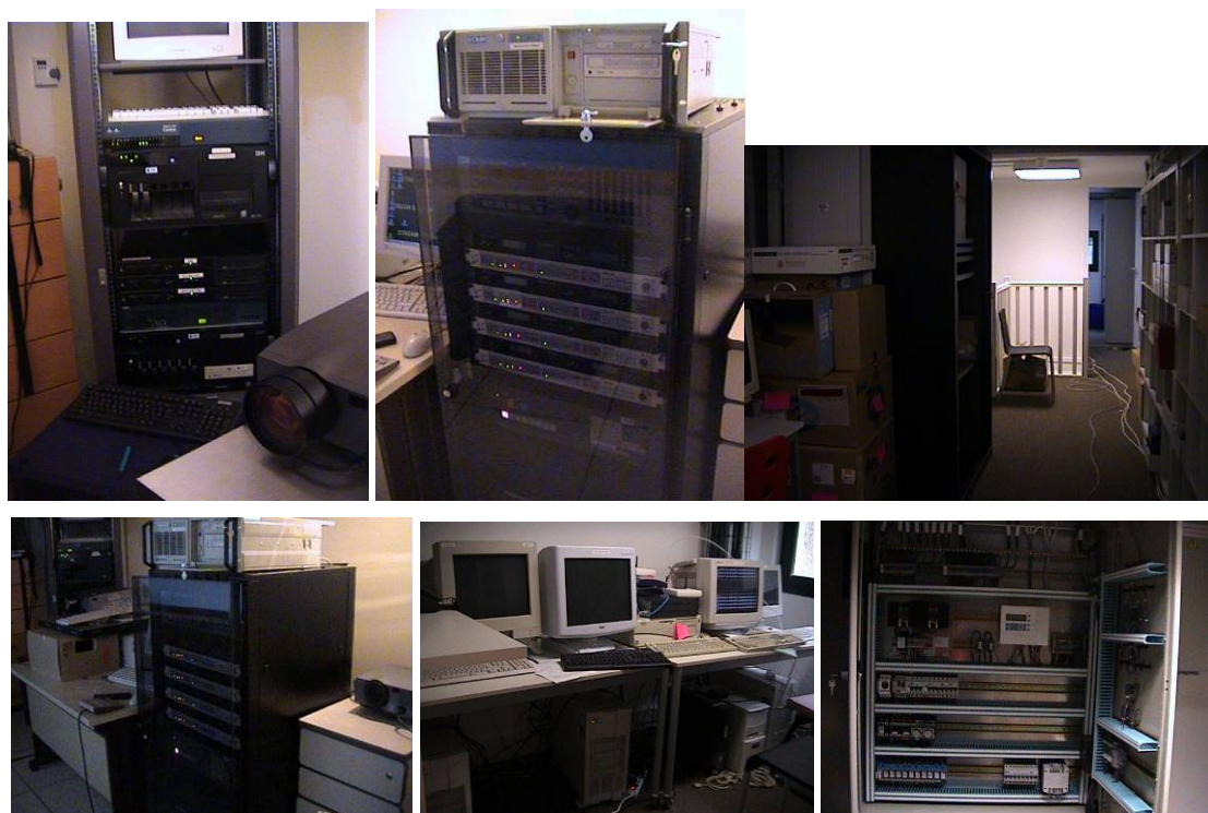
Figure 27 : Locaux techniques du K1 (décembre 2000)
