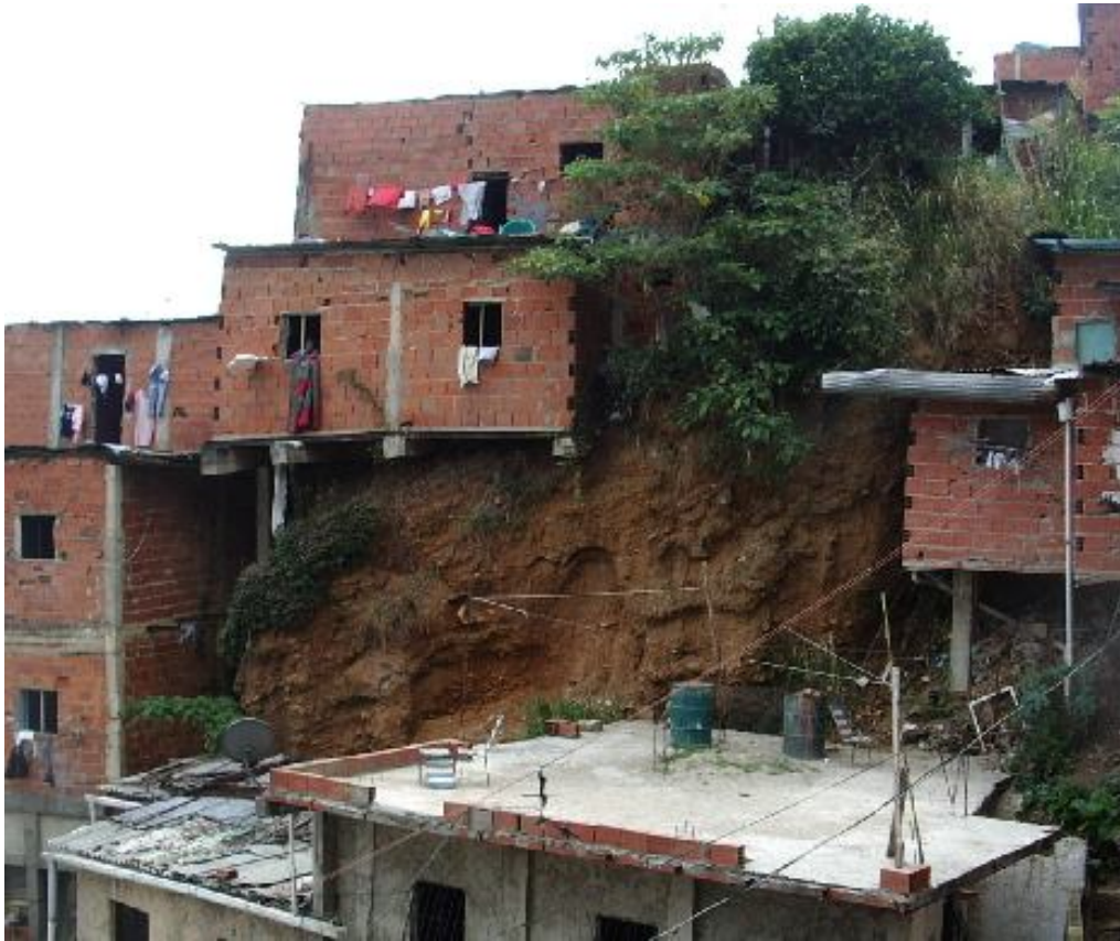
Photo 17. Un Rancho dangereusement avancé dans le vide et appuyé sur un terrain friable dans le barrio Canaima (Source : cliché Romain Migus).
