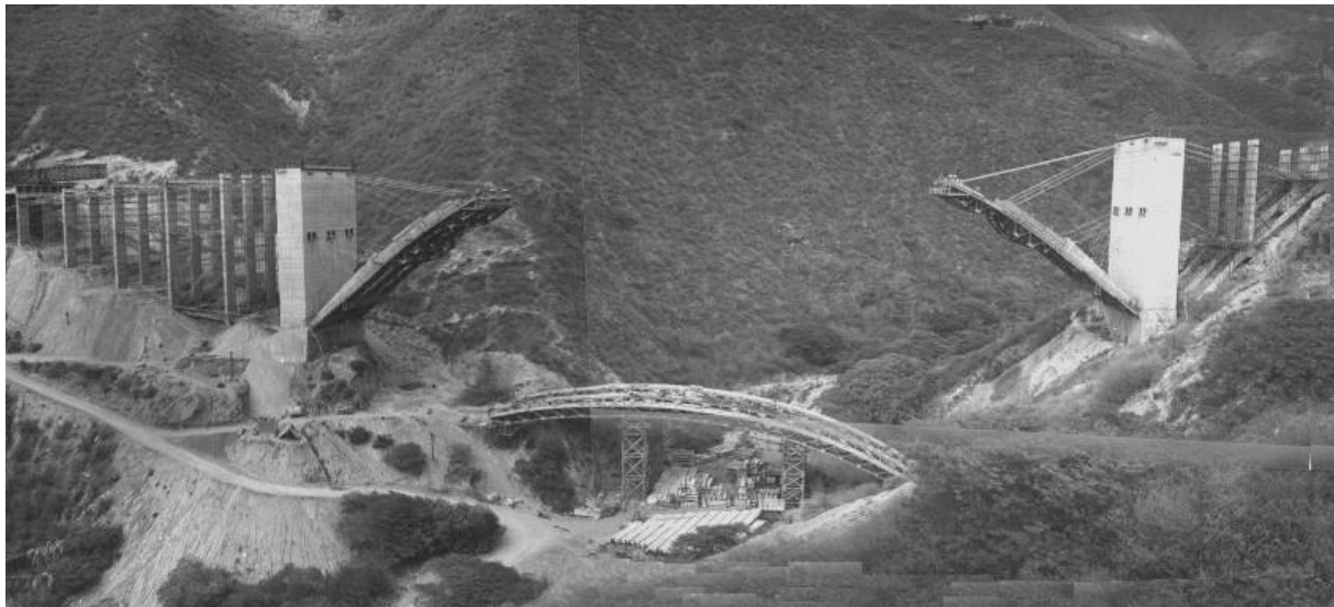
Photo 3. Technique originale utilisée pour installer la partie centrale de l'arche unique du viaduc numéro 1 (Source : Tiré de la page web : http://www.geocities.com/spulidos/P_Historia.html )
