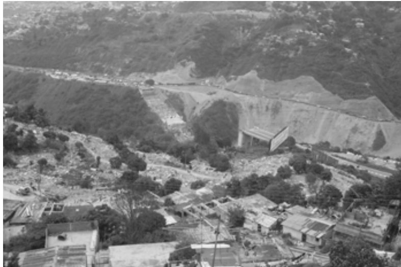
Photo 7. Vue du viaduc effondré, de la file d'attente et de la déviation, depuis Nueva Esparta (source : El Universal 19 mars 2006).
