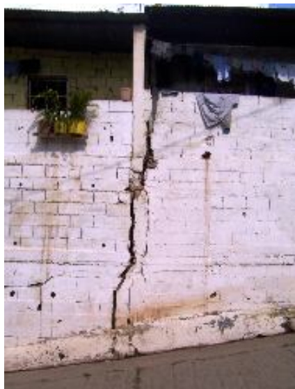
Photo 20. Détail d'une des maisons aux murs fracturés dans le secteur Latolandia (Source : Cliché de l'auteur)
