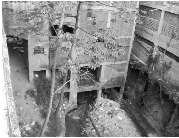
Photo 29. Construction non achevée sur pilotis dans le lit mineur de la quebrada Catuche canalisée (Source : Cliché de l'auteur, 2007).
