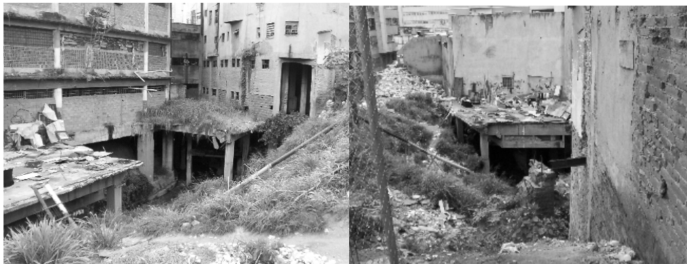
Photo 30a et 30b. Edifices délabrés dans le centre historique, au Nord de la Plaza Bolivar sur le cours de la quebrada Catuche
