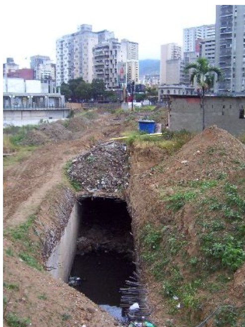
Photo 27. Conduite ouverte de la Quebrada Anauco quelques mètres avant de passer sous le complexe du Parque Central (Source : Cliché de l'auteur, 2007).
