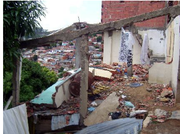
Photo 11. Glissement isolé sur un versant du barrio Mario Briceño Irragory (Source : Cliché de l'auteur)
