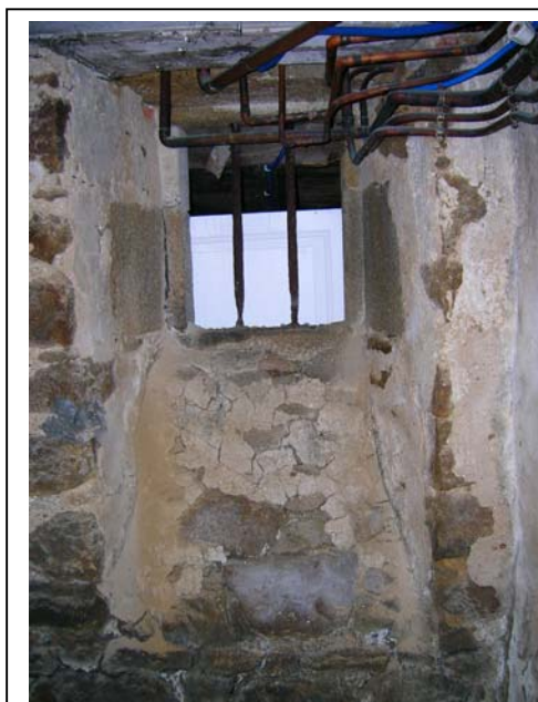
Fenêtre ornée de barreaux avec allège en glacis du N°6 rue Carnot, fin XVIIe, maison Gravé de la Rive.
