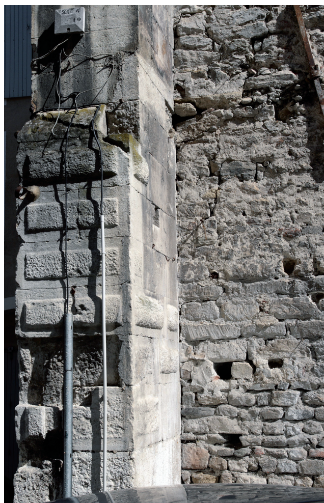
Fig. 19. Contrefort extérieur du mur gouttereau sud de l'église abbatiale Saint-André-le-Haut de Vienne (Isère). Cliché : A. Baud et A. Flammin, Université Lyon 2-UMR 5138.
