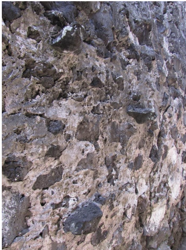
Figure 87 : détail du parement : blocs en saillie, servant peut-être à l'accès aux parties hautes
