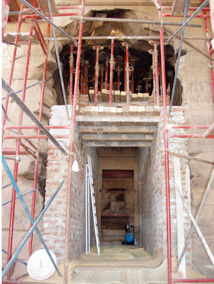
Fig. 12. Dans la salle des offrandes, un mur de soutènement avec un solide plancher a été installé provisoirement durant les travaux de restauration. Sur le plancher, une forêt des chandelles métalliques permettent de soutenir individuellement les fragments instables du plafond. © Cnrs-Cfeetk/E. Laroze.
