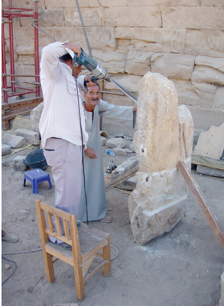
Fig. 21. Mahmud Saïd Ahmed avec l'aide d'Abdou Quoraïem perce le bloc n° 2408. Une tige en acier galvanisé, enrobée dans de la résine, est ensuite insérée dans le trou afin de solidariser les différents fragments. © Cnrs-Cfeetk/E. Laroze.
