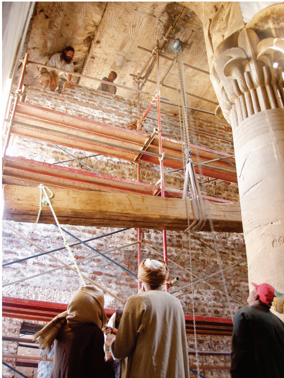
Fig. 8. Le mur de soutènement provisoire en briques dans la salle hypostyle. Une poutre en bois est hissée pour être placée sous le plafond afin de répartir convenablement les charges sur le mur. © Cnrs-Cfeetk/E. Laroze.
