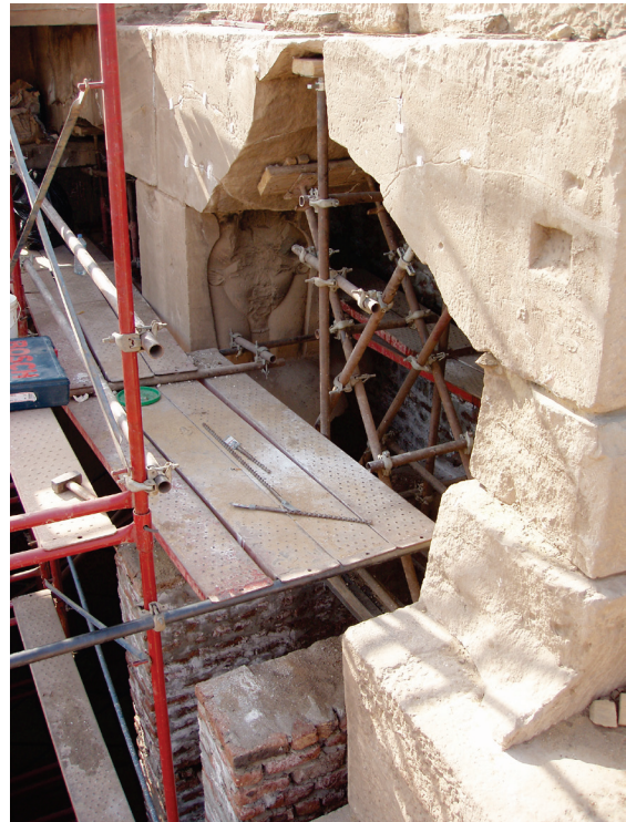
Fig. 9. L'étalement de l'architrave nord-ouest avant sa restauration. Dans le bas de la photo on aperçoit le mur de soutènement en brique. © Cnrs-Cfeetk/E. Laroze.
