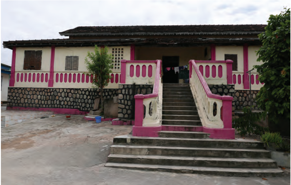
La résidence d'Obodji Soboa , au quartier Obodjikro à Agboville, lui servait aussi de lieu de réception. Elle n'est plus habitée mais est préservée et a relativement bien résisté au temps. En 2019, toutefois, sa toiture était en partie effondrée. Les pièces et quelques éléments du mobilier d'époque, dont un élégant sommier de lit avec poteaux en métal, témoignent du faste du train de vie de ses habitants (cliché de l'auteur, juillet 2019).
