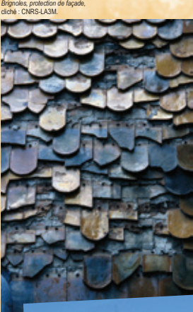
Brignoles, protection de façade, cliché : CNRS-LA3M.
