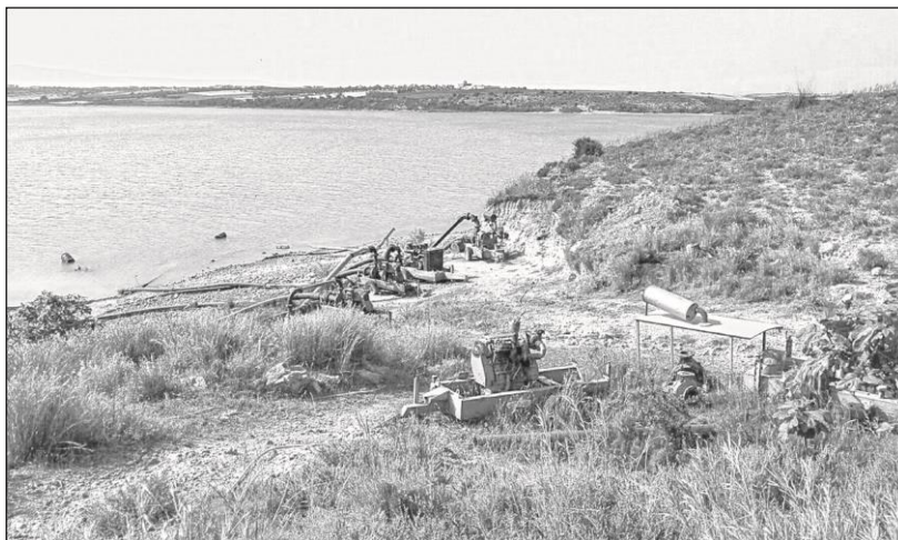
Photo 1 : Puissants groupes de motopompes installés sur le barrage du Lebna par des agriculteurs
