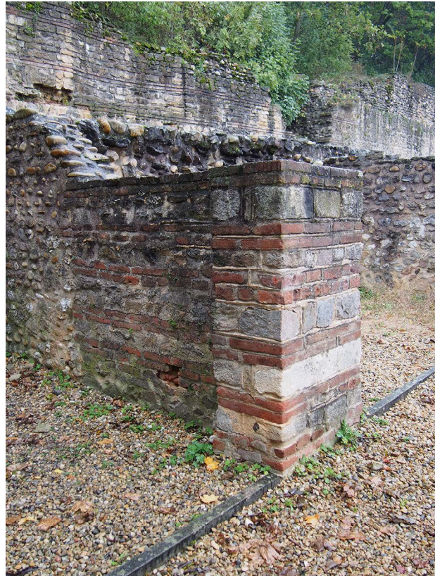
Figure 2. Boutiques à l'arrière de l'odéon, Lyon : entrée encadrée par des antes en opus mixtum Cliché M. Lépée
