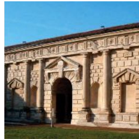
Fig. 1 - Cour intérieure du palais du Té à Mantoue (Giulio Romano, XVI e siècle : des pièces maîtresses de l'architrave ont glissé, mettant virtuellement en danger la stabilité de l'édifice (© Marco/Wikipedia).
