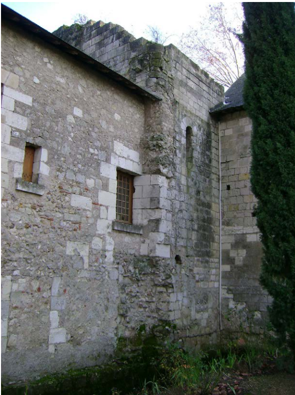
Photo 165 : l'extrémité nord de l'aile orientale du carré claustral avec le bâtiment accolé (« garage à bateaux ») (vue de l'est)
