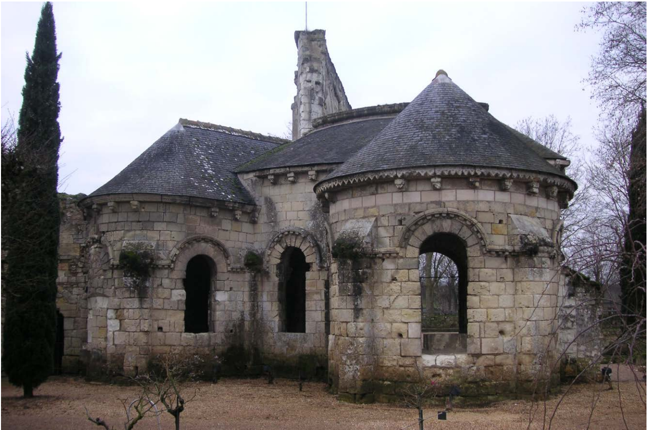
Photo 124 : les deux chapelles rayonnantes et le déambulatoire, vus de l'est. À droite, la chapelle axiale (photo prise avant la fouille, on observe les remontées d'humidité au bas des murs)
