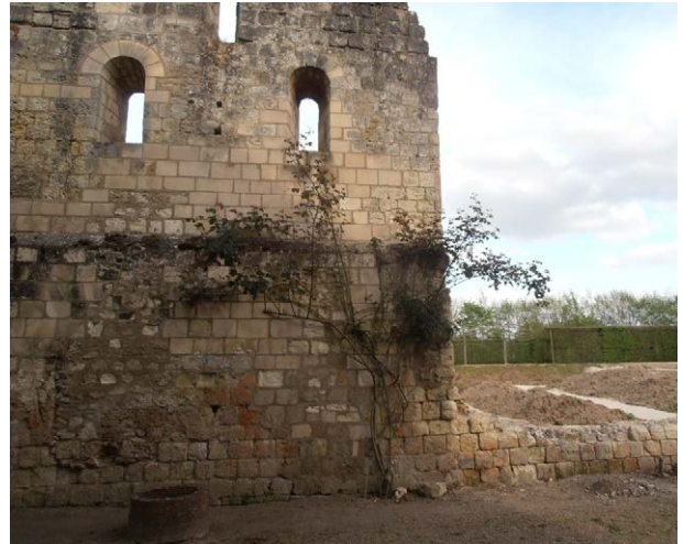
Photo 179 : le parement interne du mur gouttereau oriental de l'aile orientale du carré claustral, M 56 (extrémité sud de la partie conservée, vue de l'ouest)
