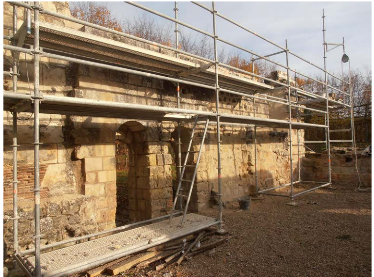
Photo 247 : le parement interne du mur nord en cours de restauration (vue du sud-ouest)
