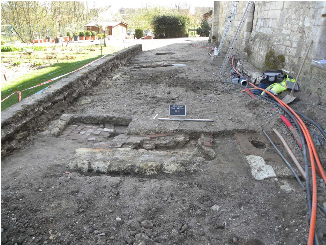
Photo 367 : bâtiment annexe du logis du prieur, accolé à son gouttereau oriental (vue du nord)
