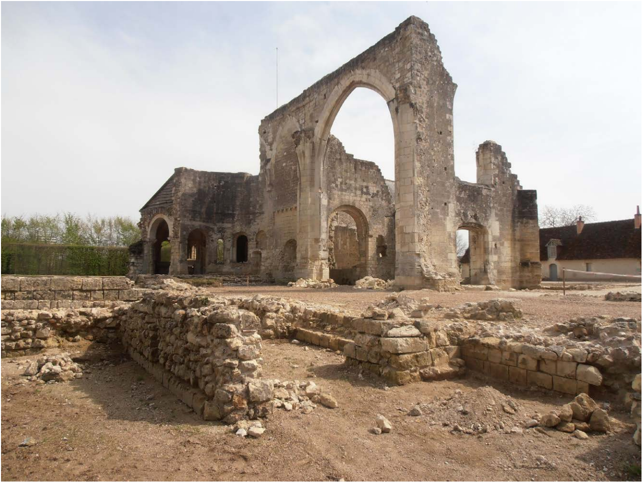
Photo 94 : vue d'ensemble de l'église et de la galerie du cloître, depuis le nord-ouest (vue prise en mars 2014, lors du piquetage et purge des maçonneries en vue de leur restauration)
