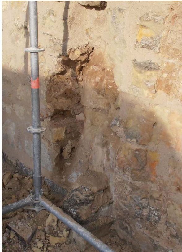
Photo 245c : détail d'un sondage dans le bouchage de la cheminée EA 1368, montrant le départ du contrecœur concave du premier état (vue prise pendant la restauration)
