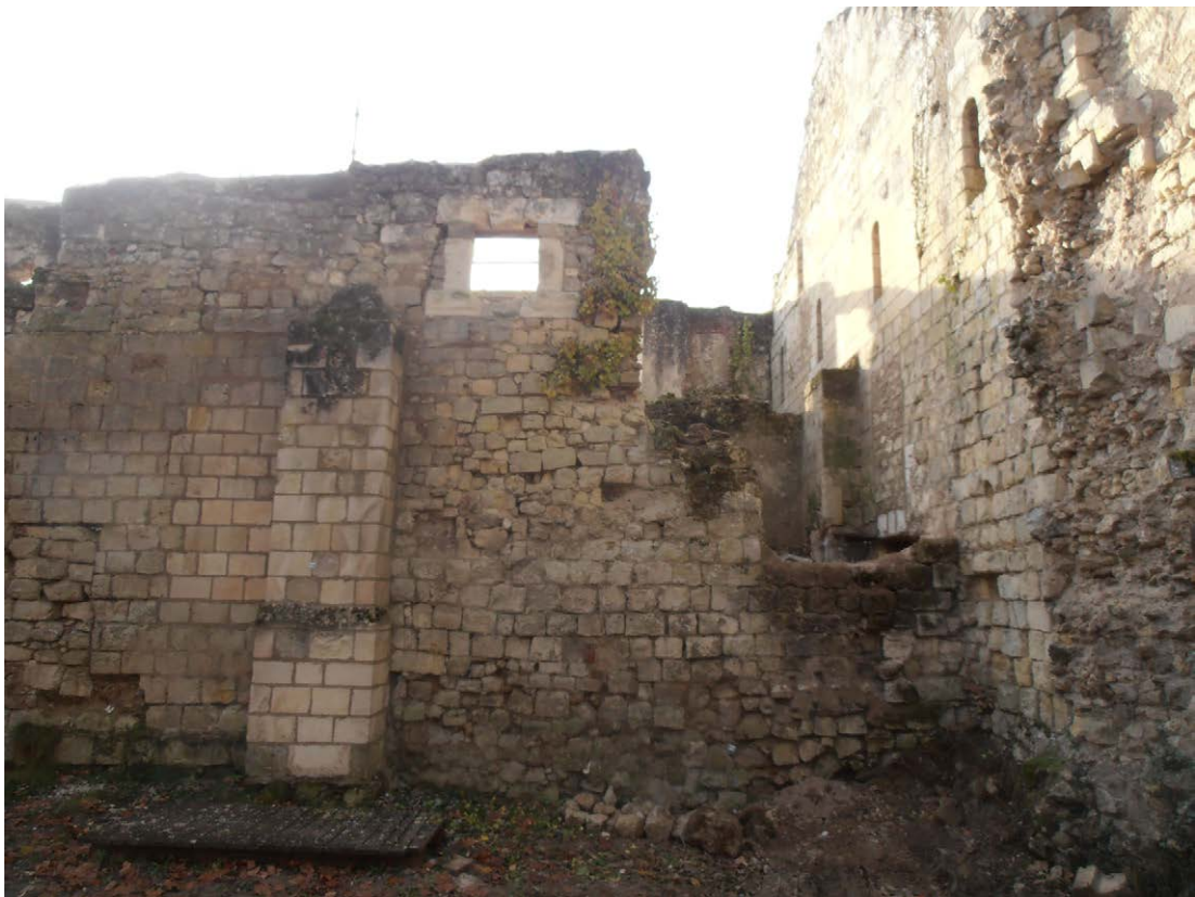
Photo 242 : l'extrémité ouest de la façade nord du « régulier » après la dévégétalisation de 2014 (vue du nord)
