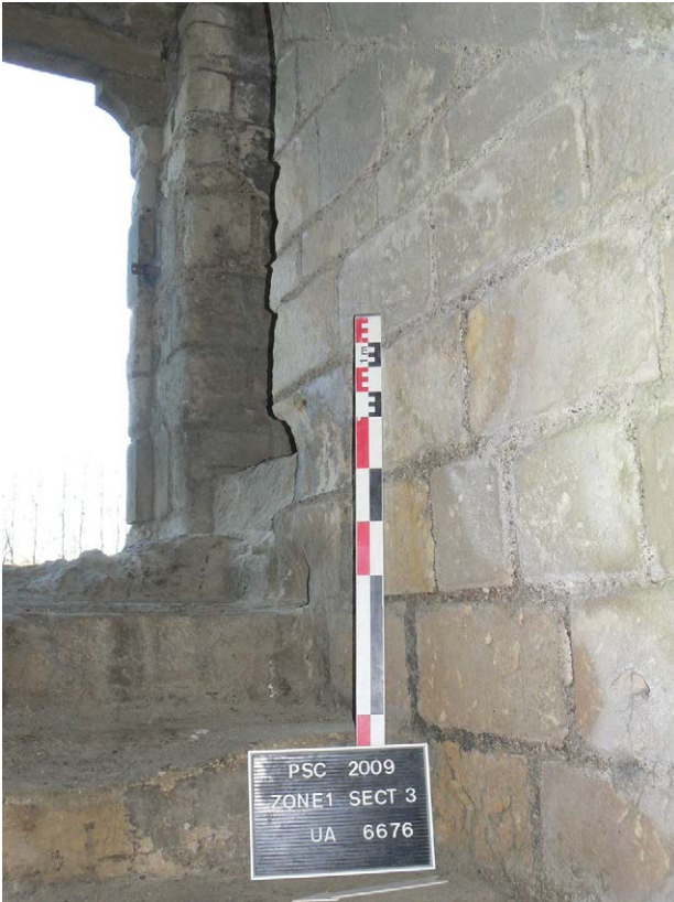
Photo 292 : le palier entre l'escalier EA 618 (descendant vers la cave) et l'escalier EA 622 (montant vers le logis) ; à l'arrière-plan, la porte d'accès au logis EA 615)
