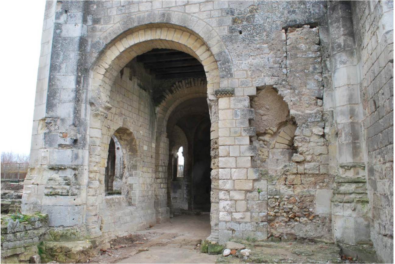
Photo 97 : l'entrée du déambulatoire dans le bras sud du transept (vue de l'ouest)t
