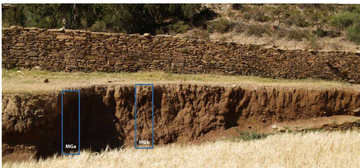
FIGURE 4.9 – Vue panoramique de la partie droite de l’accumulation de Mengangebit. Les deux coupes sont localisées par des rectangles bleus. Cliché : N. Blond, 2017.
