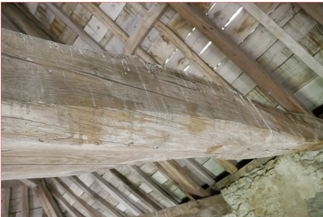
Photo 3 (en haut) : Mortaine rebouchée au centre de la face est (pour un coyer) de l'entrait de la ferme centrale. Photo 4 (en bas) : Mortaise rebouchée côté nord de la face est (pour un gousset) de l'entrait de la ferme centrale.
