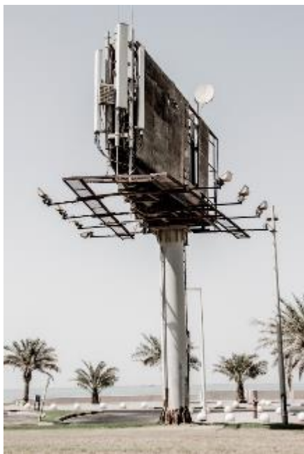
Photographie 7 : Panneau-antenne sur la corniche de Koweït, © Manuel Benchetrit, 2017.
