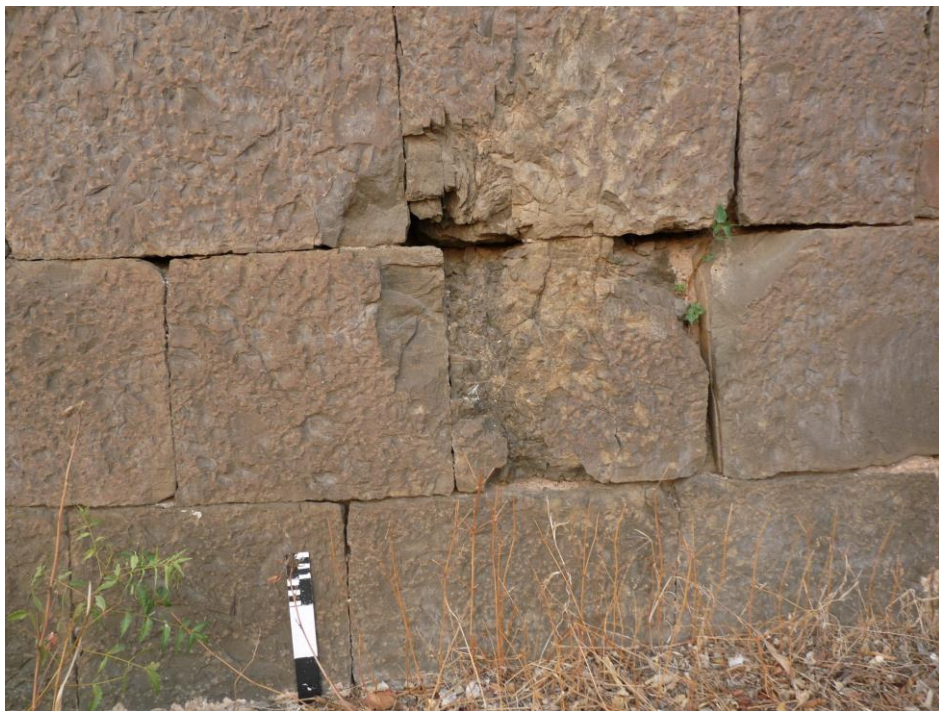
Figure 126 : marque de boulet dans la fortification de Naldurg (front sud)
