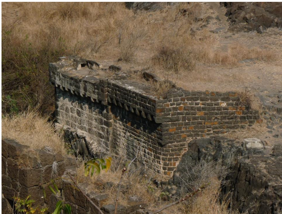
Figure 37 : installation surplombant le fossé au nord du Naya Qilah (relation au montage de l'eau ?)
