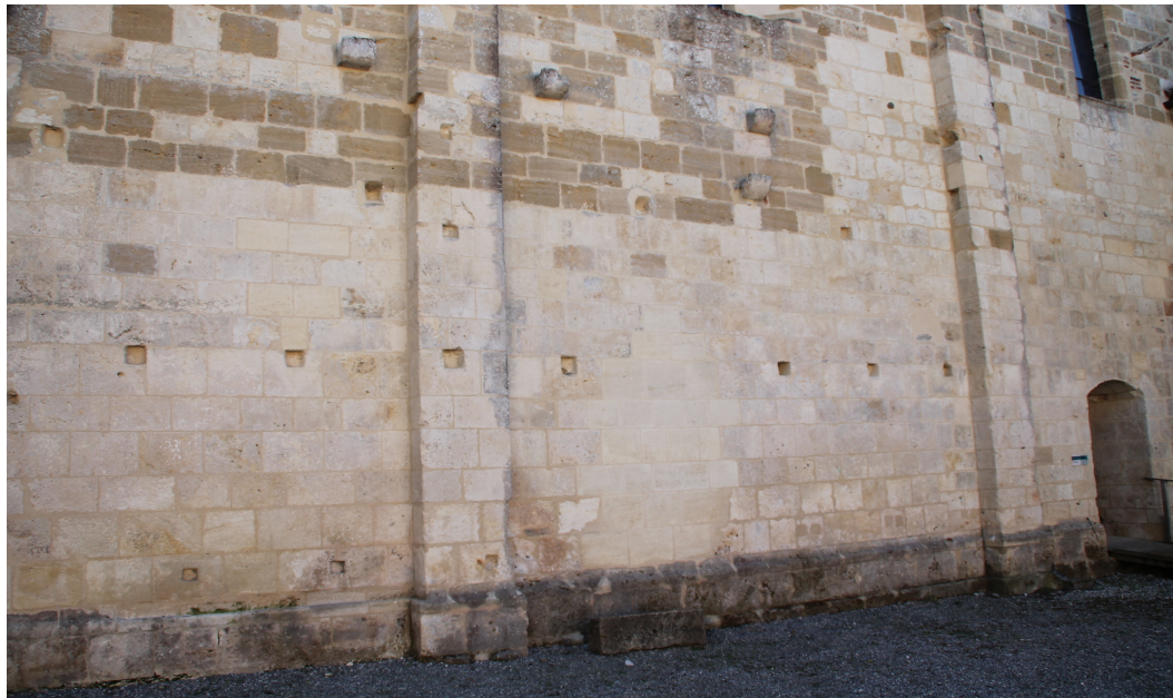
Doc. 4. Vue du mur gouttereau nord de la nef, côté cloître. On remarque une série de percements destinés à accueillir les solives des deux étages disparus du cloître, mais aussi des percements plus bas qui supportaient sarcophages et plaques funéraires. Photo S.A. 2017.
