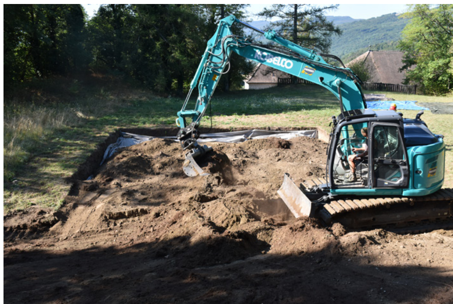
Fig. 7 a et b : Rebouchage mécanisé des emprises de fouille après le départ de l'équipe de terrain. Cliché : Equipe de fouille.
