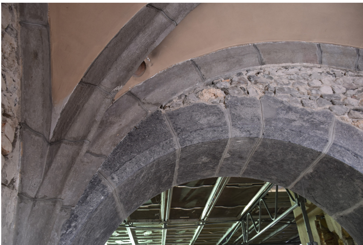
Fig. 37 : Détails de l'arc d'entrée dans la chapelle latérale ES 2.3. Cliché : L. Benoit (UAPB).
