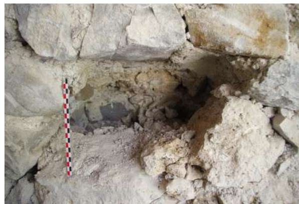
Fig. 55 : Arrachement dans le parement où est visible le doublement du mur par l'extérieur.
