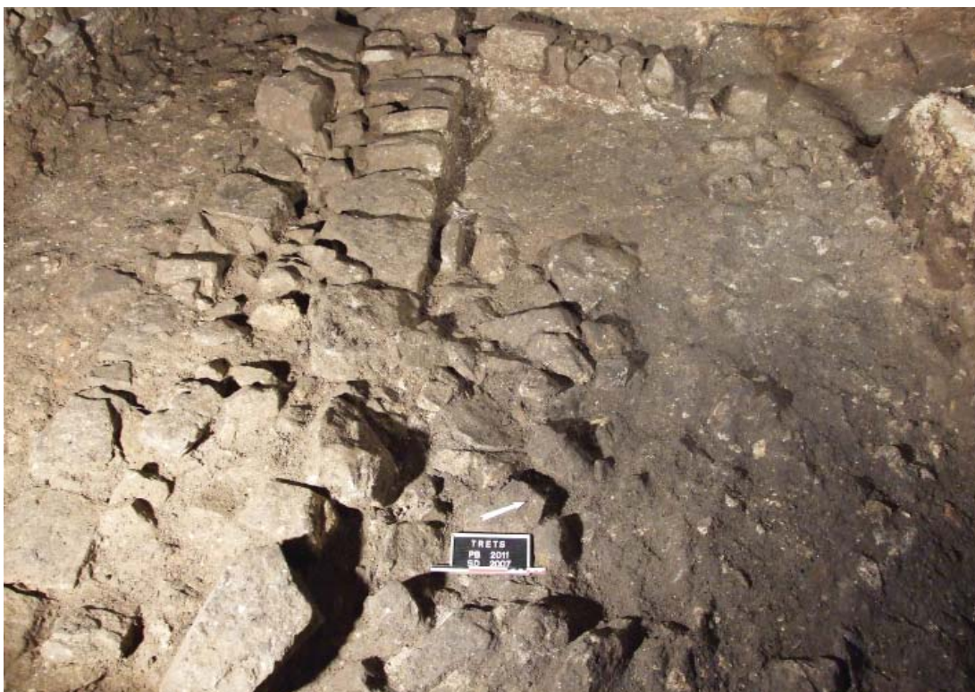
Fig. 30 : Effondrement du mur MR2011 (US2007)
