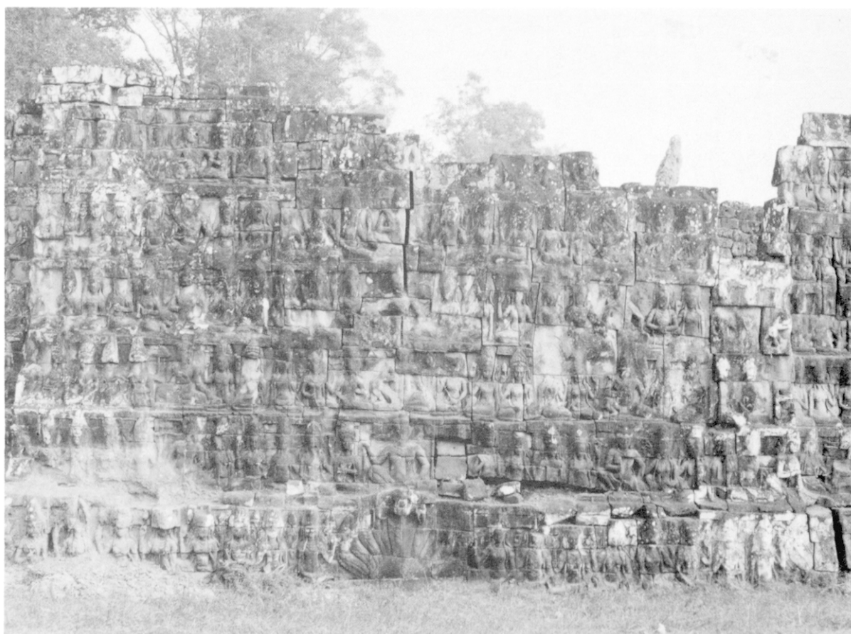
Fig. 3. Terrasse du Roi lépreux, le mur externe Sud, état actuel (cf. J. Dumarçay).
