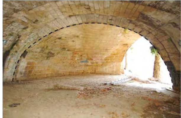
Fig. 5. Déformation de l'arc de la neuvième arche, située sous le quai rive gauche (cliché V. Mathieu – CNRS).
