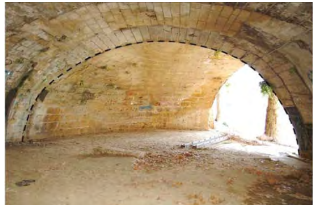
Fig. 5. Déformation de l'arc de la neuvième arche, située sous le quai rive gauche (cliché V. Mathieu – CNRS).
