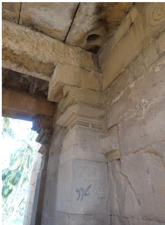
Figure 69 : détail de la colonne modifiée de la porte 16a et de la crapaudine haute pour l'installation d'un gond d'une porte tardive
